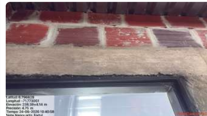
Fisuras finas horizontales en la cara inferior de una viga; no se observa acero expuesto en esta imagen.
