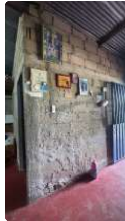
Juntas verticales alineadas, traslazo irregular y fisuración escalonada en la parte superior del muro.
