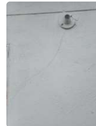
Fisura diagonal ramificada que desciende desde la parte alta hacia el centro del paño.
