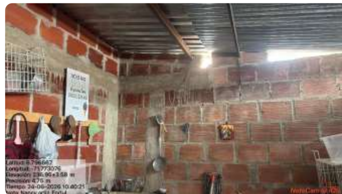
Interrupción visible de la viga de amarre en el encuentro entre muros y aparejo irregular en bloque.
