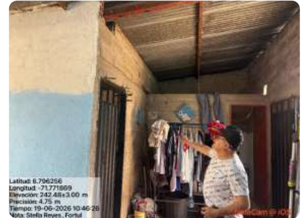
Cubierta metálica apoyada sobre los muros; se aprecia separación superior y corrosión en elementos de soporte.
