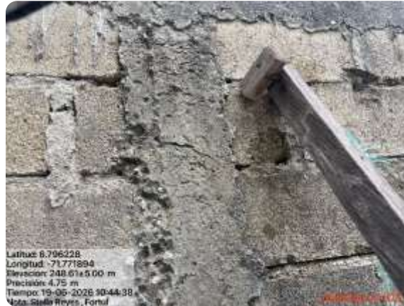
Porosidad y segregación visibles en concreto, fisuración localizada y pérdida de mortero en juntas de mampostería.
