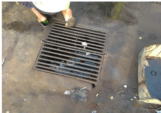
Foto 5: El aceite usado muchas veces va a parar directamente al alcantarillado.
