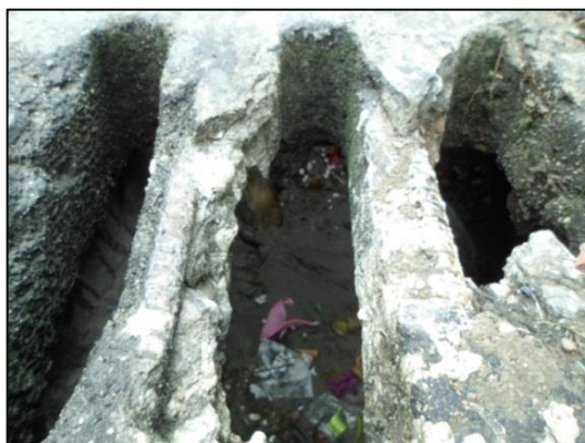
Figura 35. Depósito de arena en alcantarilla. Fuente: Propia.
