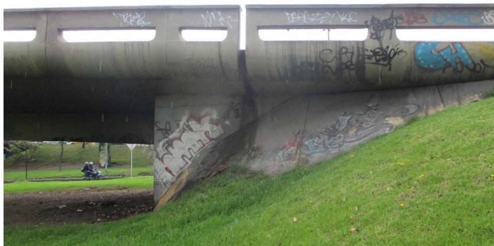
Figura 21 Lesiones en el estribo y estructura de aproximación del puente.
