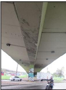
Perdida de recubrimiento por impacto
