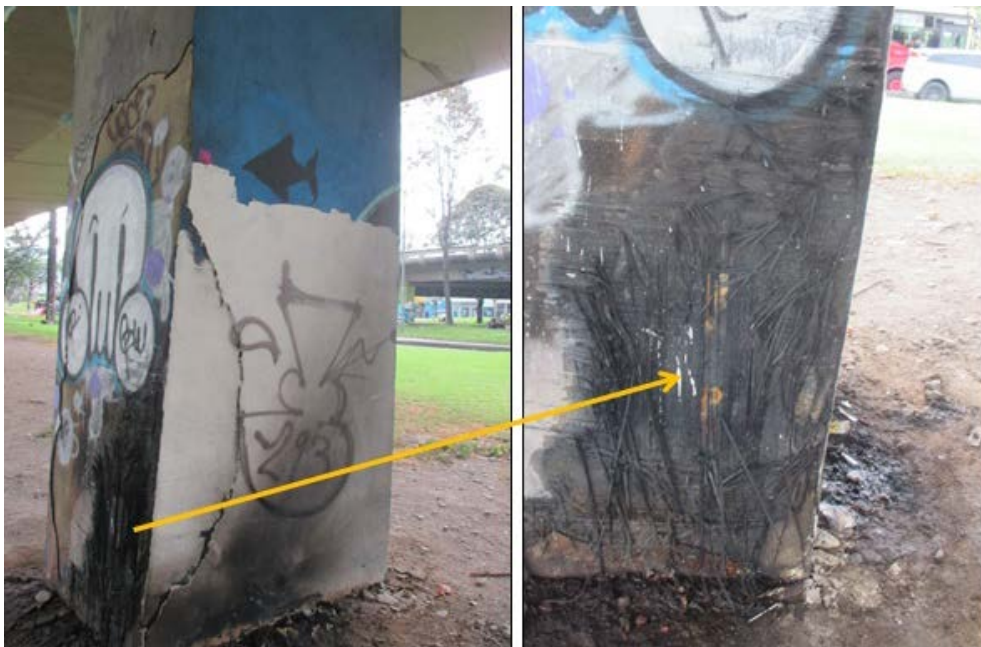
Figura 23 Columnas con pérdida de reforzamiento
