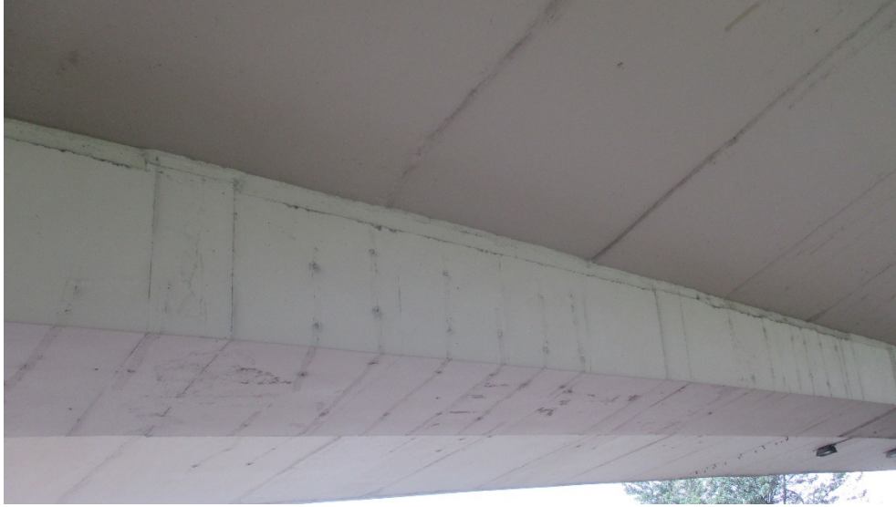
Figura 14 Lesión Física Fisuras de soporte
