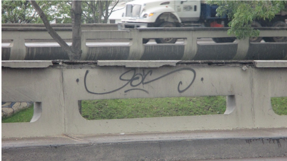
Figura 16 Lesión por desprendimiento de acabados de cenefas en barreras de protección.
