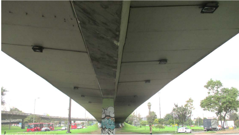
Figura 9 Lesión de Contexto - Pérdida de recubrimiento por impacto
