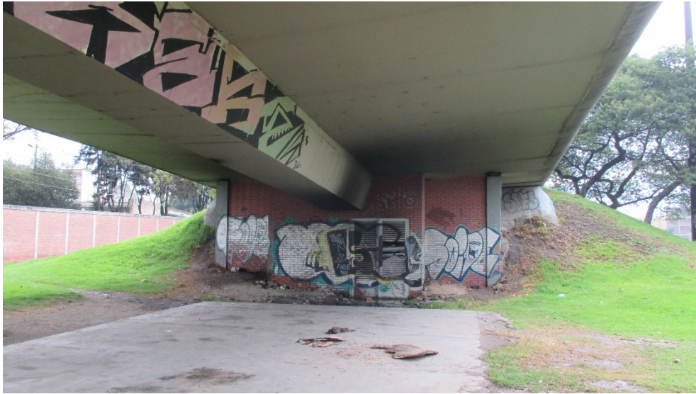
Figura 10 Lesión Física – Suciedad Manchas por combustión
