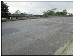
Fisuras en la carpeta
