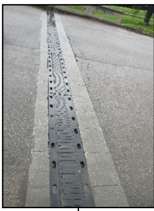
Fisuras en la superficie de rodadura en zona de junta de dilatación
