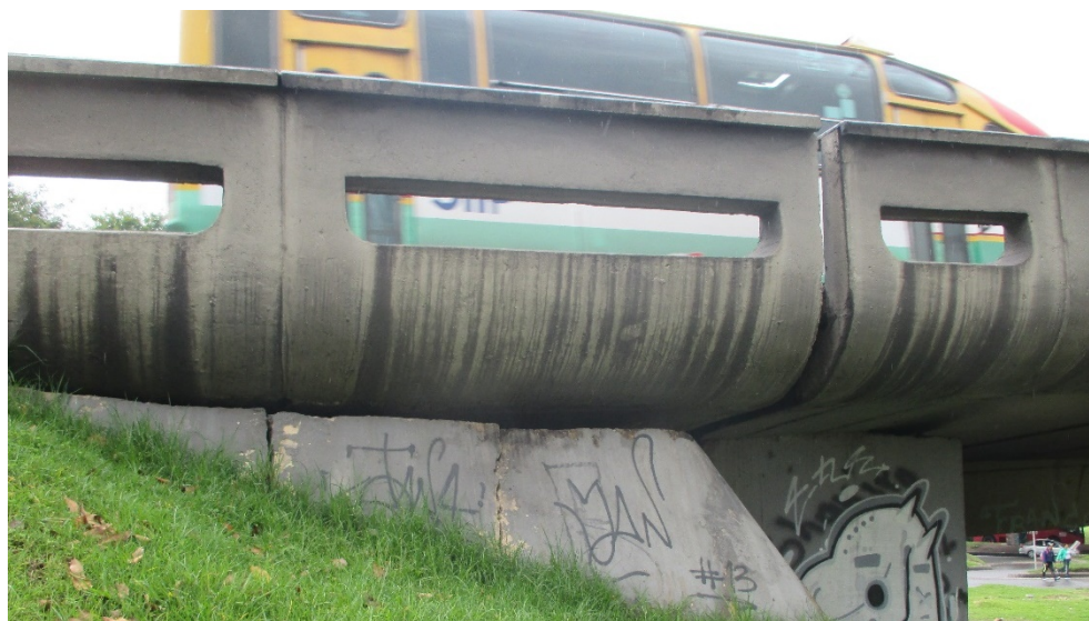
Figura 12 Lesión Física Suciedad por depósito y por lavado diferencial
