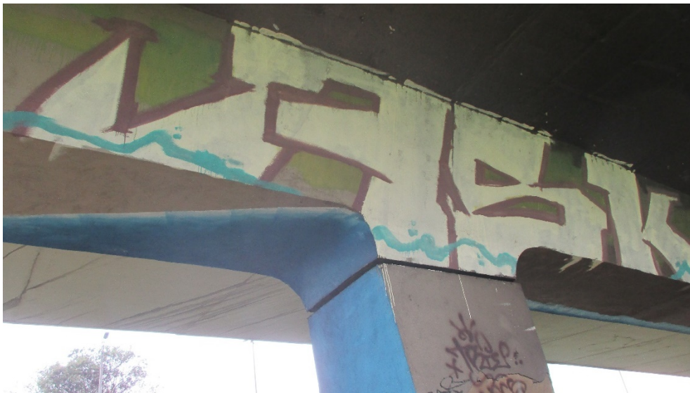
Figura 11 Lesión Física – Suciedad Manchas por combustión
