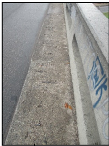
Refuerzo expuesto en sendero peatonal
