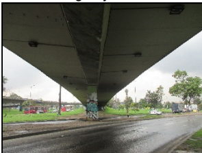
Manchas por combustión en vigas y losa
