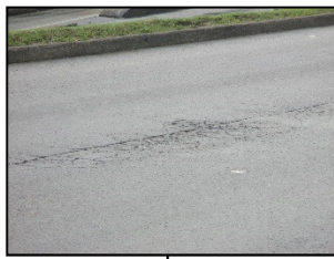
Baches en carpeta asfáltica
