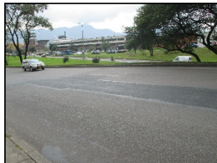
Carpeta asfáltica con reparcheos
