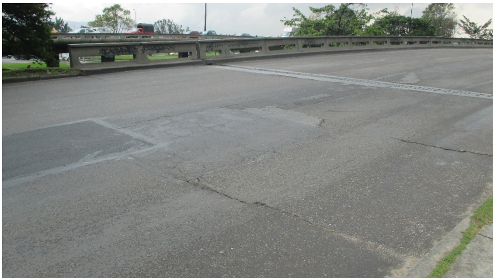
Figura 20 Lesión mecánica en carpeta asfáltica
