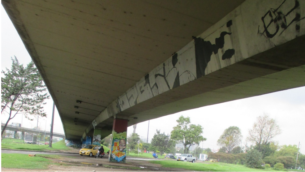
Figura 22 Lesiones físicas por humedad y suciedad en la subestructura
