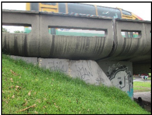
Fisuras en estructura de aproximación
