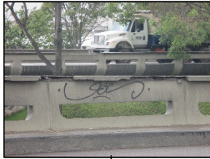
Perdida de elementos de baranda
