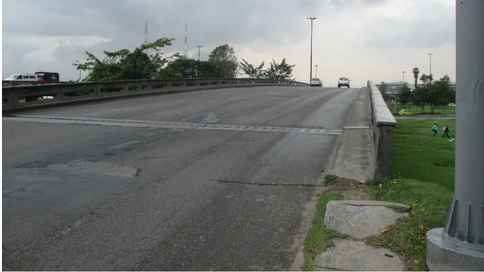
Figura 19 Lesión mecánica en carpeta asfáltica
