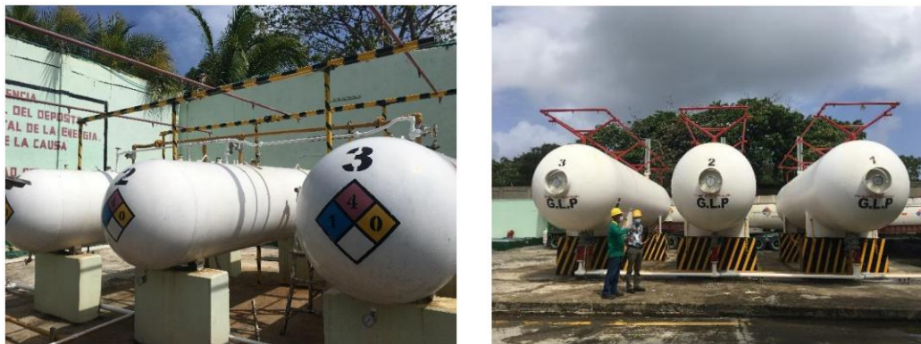
Ilustración 8. Tanques de almacenamiento Islas 1 e Islas 2
