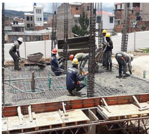
Ilustración 34 Acompañamiento fundida de la losa de entrepiso nivel 2
