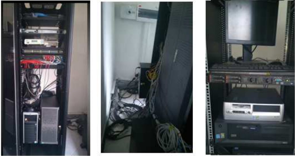
Figura 6.6. Rack actual de la compañía
