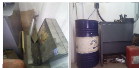
Fig. 4. Riesgo locativo y químico, por almacenamiento de elementos y sustancias inadecuadas dentro del cuarto de Ascensor, Fuente: Autor
