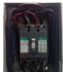
Fig. 3. Breaker de protección a 100 A, Fuente: Autor
