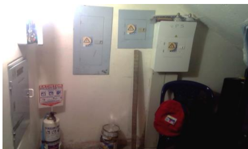
Fig. 1. Cuarto técnico, instalaciones eléctricas oficinas del edificio A, universidad Santo Tomás, sector de recepción. Fuente: Autor
