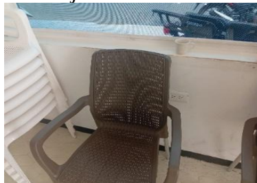
Figura 25. Falta de señalización de voltaje en el área de la sala de espera.
