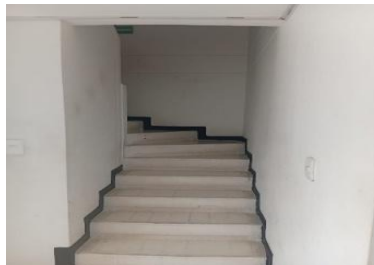
Figura 28. Falta de cinta antideslizante en las escaleras del CEA.
