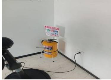
Figura 26. Falta de señalización de voltaje y organización en el área de la sala de espera.
