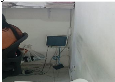
Figura 18. Falta de canalización y señalización de los cables en el área de recepción.
