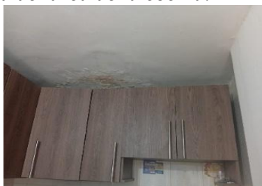
Figura 34. Alteración de la estructura del área de la cocina.
