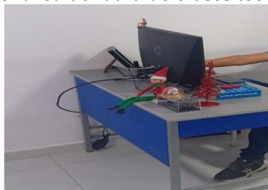
Figura 33. Falta de canalización en el área del aula de clases teóricas.
