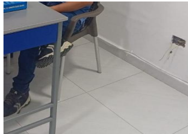
Figura 31. Daño en la toma eléctrica del área del aula de clases teóricas.
