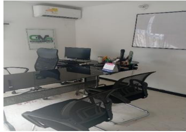
Figura 21. Falta de canalización y señalización de los cables en el área de administración.
