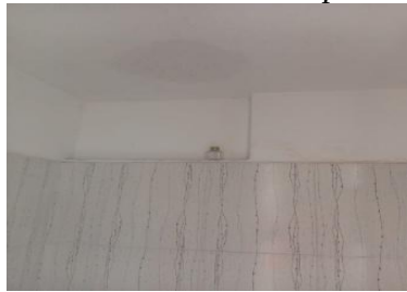
Figura 22. Alteración de estructura dentro del baño del primer piso.
