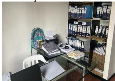
Figura 38. Falta de señalización del voltaje en el área de archivos.
