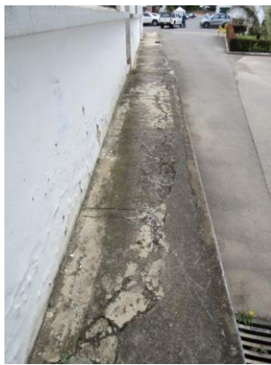
Imagen 74 Estado actual andén perimetral
