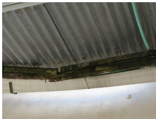
Imagen 19 Lesión en elemento estructural de cubierta
