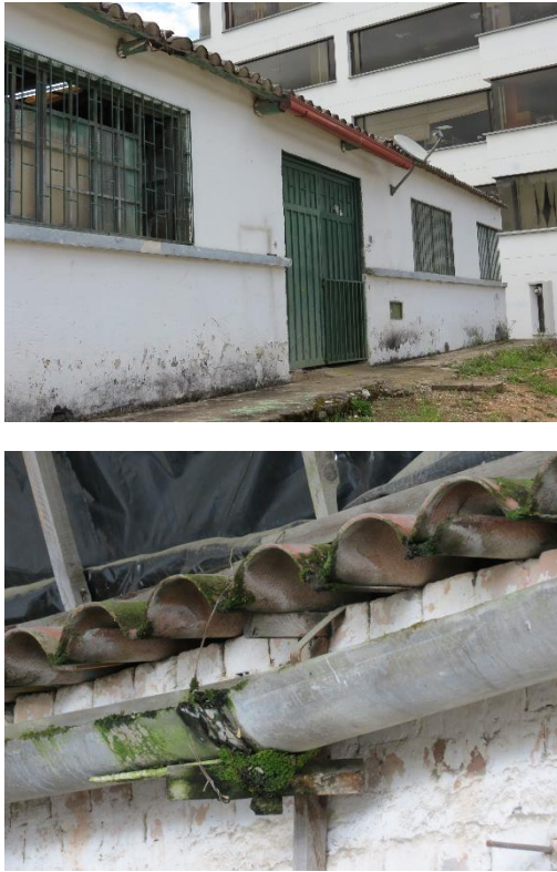
Imagen 66 Sistema de recolección de aguas lluvias actual
