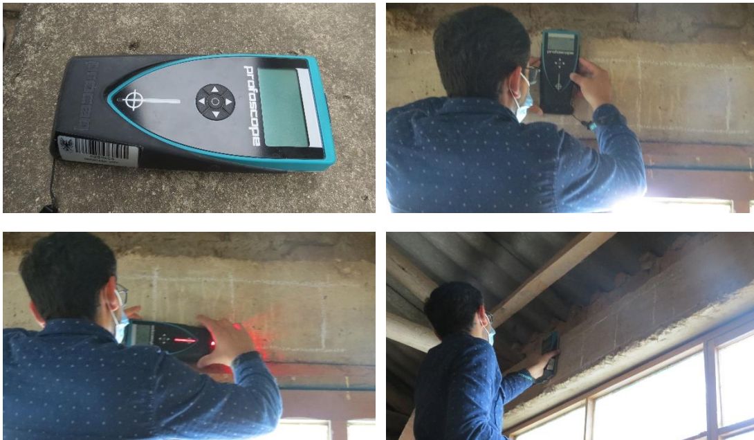
Imagen 46 Detección de aceros
