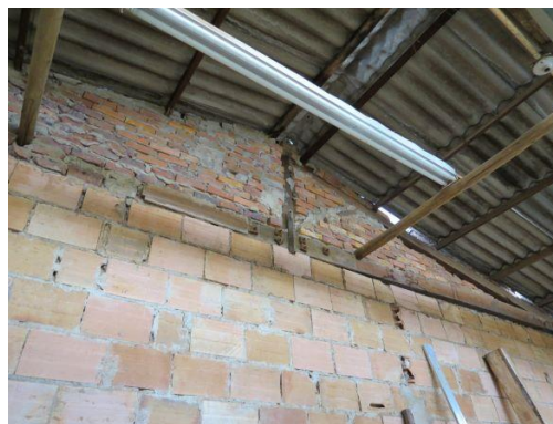
Imagen 25 Lesión por humedad
