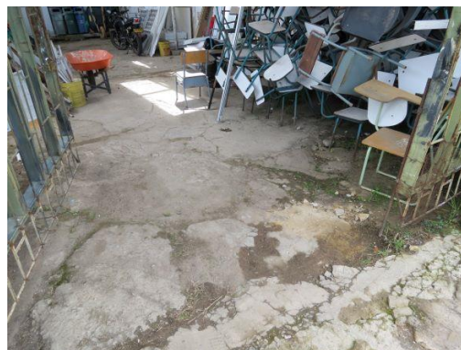
Imagen 21 Lesión fisuras y grietas en placa
