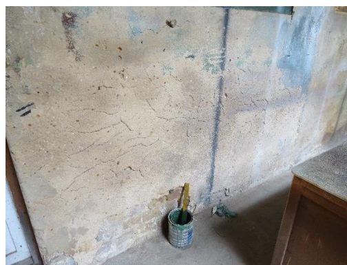
Imagen 11 Lesión grietas y fisura en muro
