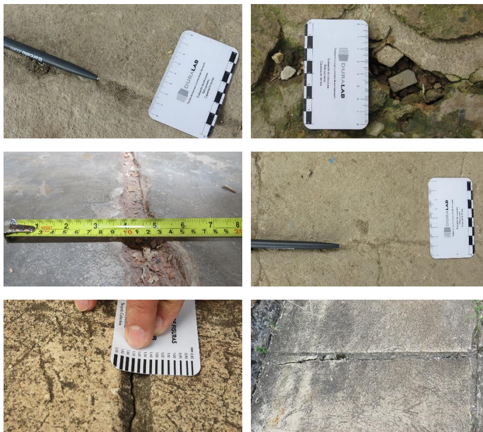
Imagen 48 Identificación y medición de fisuras en placas
