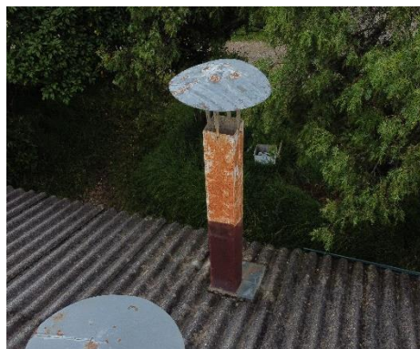
Imagen 29 Lesión por corrosión
