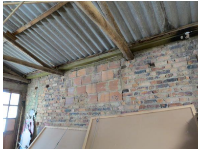
Imagen 58 Viga sin apoyo adecuado sobre muro
