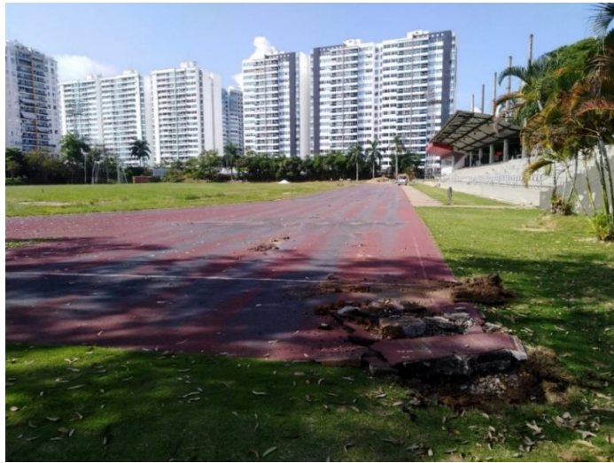
Figura 1. No cumple debido al mal estado de la pista atlética.
