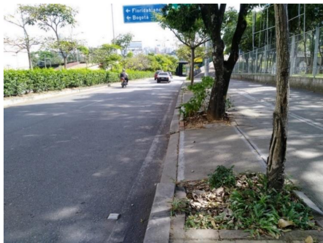
Figura 4. Mal estado del vado peatonal.
