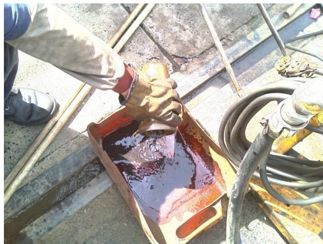
Figura 7. Extracción de residuos en filtros de la bomba succionadora.
