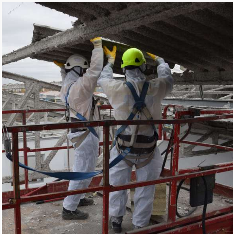
Imagen tomada de: dmol (s.f). https://dmol.co/asbesto/
