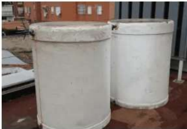
Depositos de agua de fibrocemento
