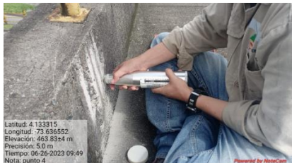
Figura 18. Bordinillo con refuerzo expuesto, Bordinillo 2
