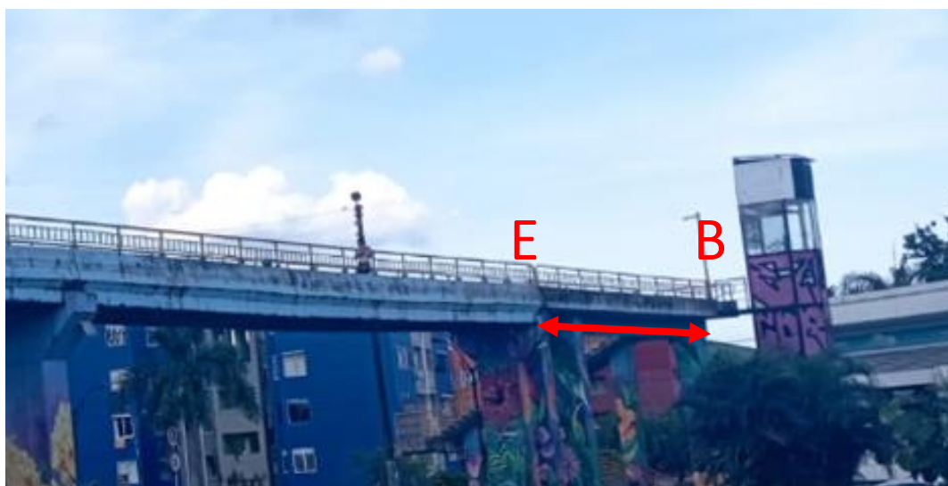
Figura 22. Los bordillos ubicados entre el eje E y B se ve más afectado que el bordillo del resto del puente.
