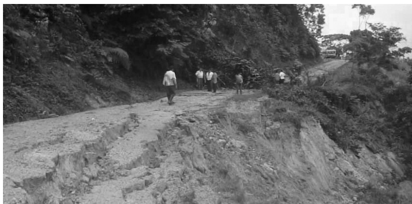
Figura 11. Derrumbe en el sector de Puerto Bello, Caquetá
