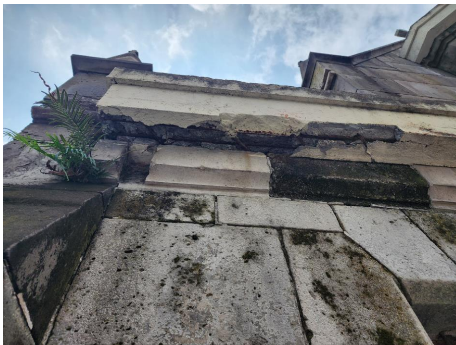
Ilustración 6. Fachada de la iglesia canaletas, oxidación del acero de refuerzo.
