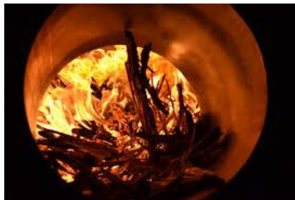
Figura 16 Bagazo de caña en caldera
