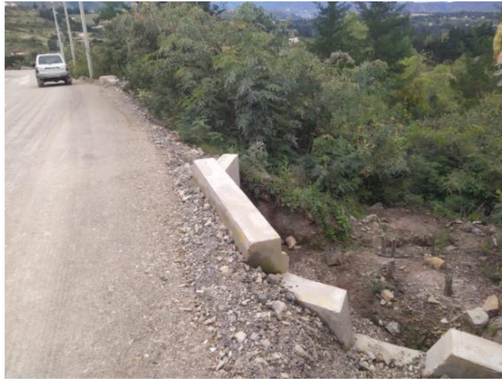
Figura 24. Alcantarilla sin señalización
