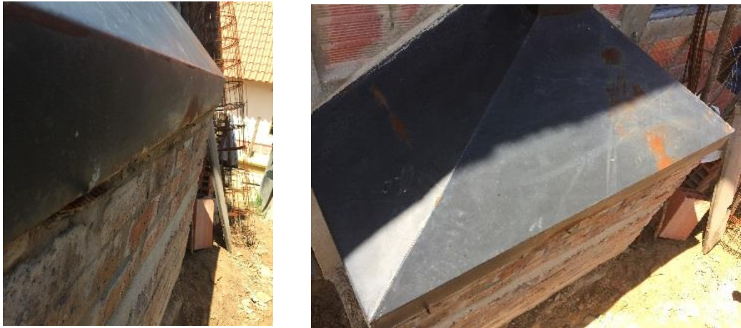
Ilustración 7. No aplicación de pintura anticorrosiva
