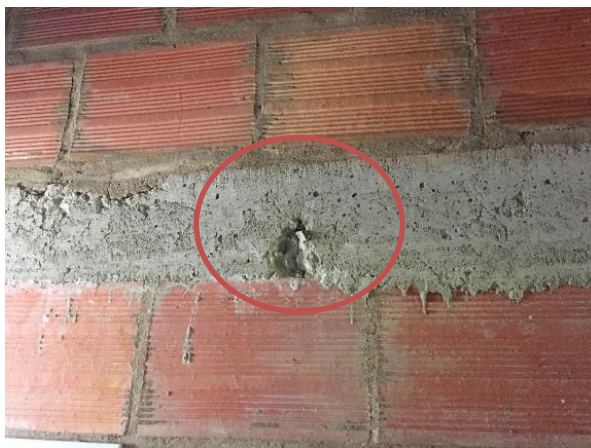
Ilustración 6. Desprendimiento de concreto, parte de la viga.
