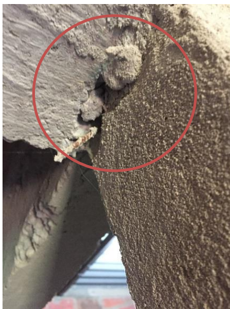
Ilustración 5. Mala transición de viga-columneta.
