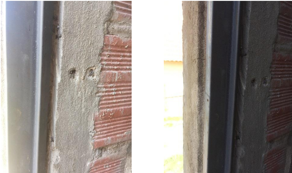
Ilustración 4. Corte de columneta comprometido el acero de refuerzo.
