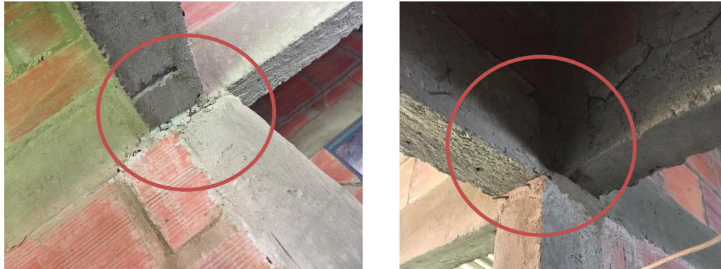
Ilustración 3. Viga corrida, exposición de flejes y mala transición de viga-columneta.
