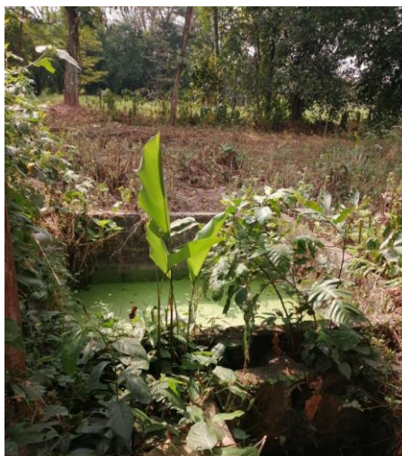
Figura 11: Estado de la cámara de descarga. Fuente: autores.
