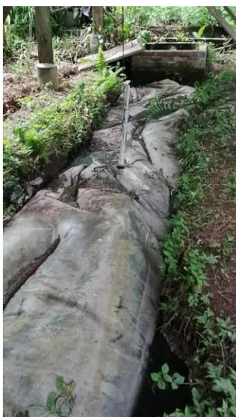
Anexo 2: Estado del polietileno del reactor. Fuente: autores.
