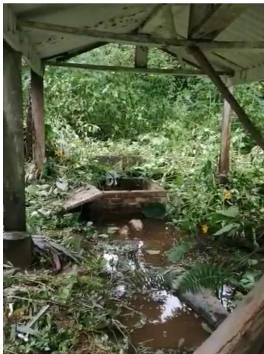
Figura 16: Tapa del tanque de almacenamiento 2.
