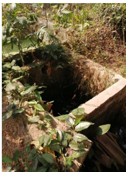
Figura 10: Estado del tanque de almacenamiento 2. Fuente: autores.
