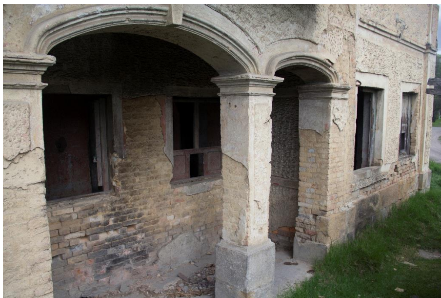
Figura 32. Vigas sin Confinamiento
