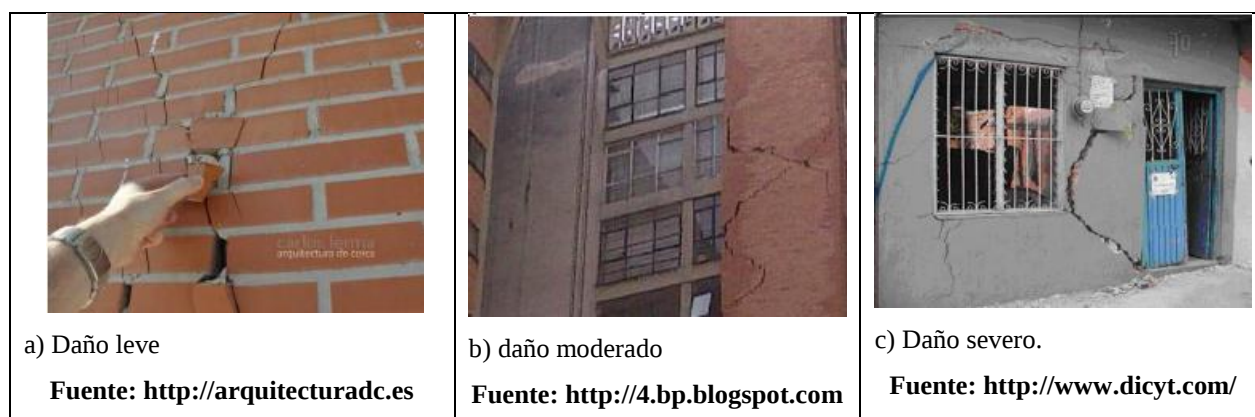
Figura 51. Fisuras y grietas provocadas por tensión diagonal.
