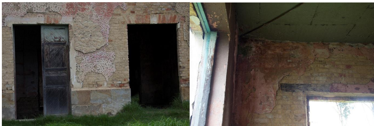
Figura 34. Muro sin Corono o Viga de Amarre
