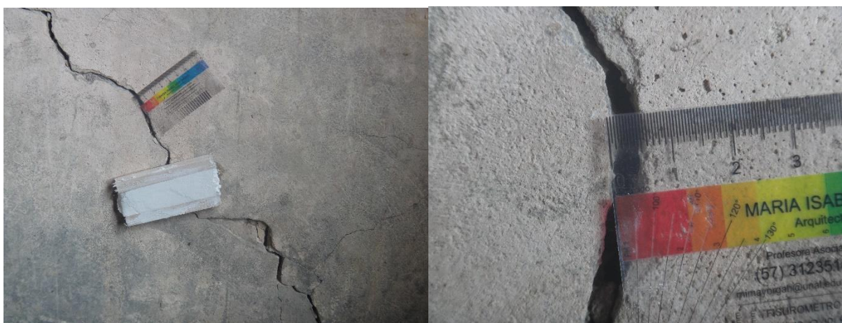
Figura 50. Fisuras en Muros
