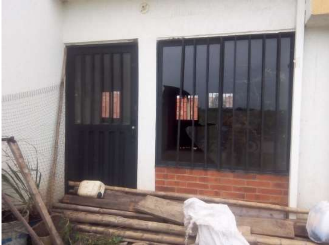
Fotografía 2. fachada de unidad de vivienda con hurto general - Villa David etapa III
