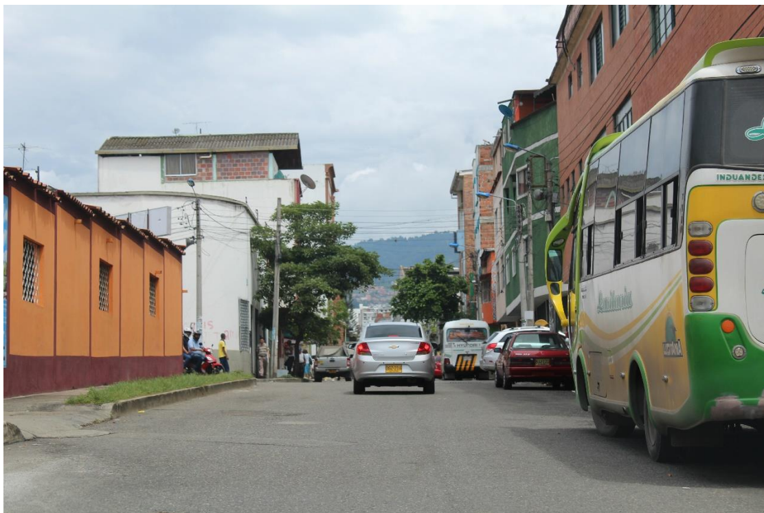
Figura 42, Estado Pavimento Calle 33.
