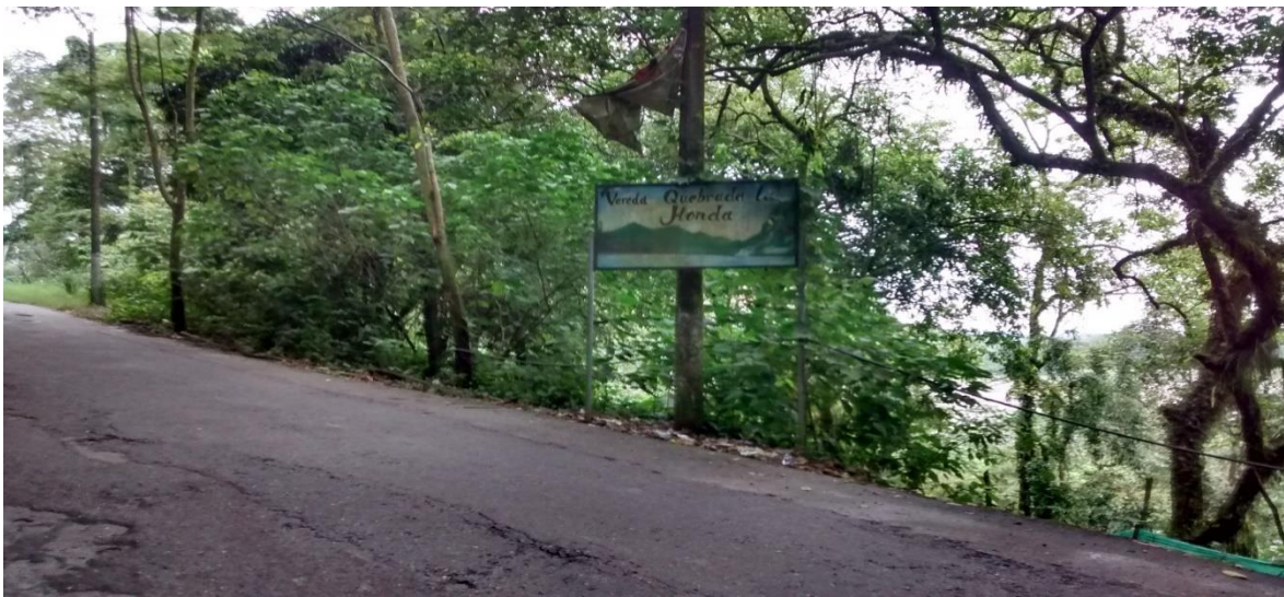
Imagen 15 Sector de Quebrada Honda, zona más afectada en el estudio. Grietas en el pavimento y gran cantidad de huecos a lo largo del tramo. Sector 2.
