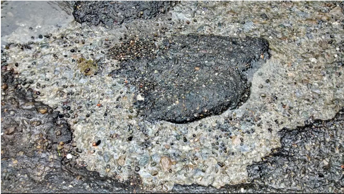
Imagen 11 deterioro de la carpeta asfáltica con visión de la base en concreto, esto se debe por el puente que se encuentra sobre la vía. Se observa aun la cantidad de agua sobre la capa de rodadura.
