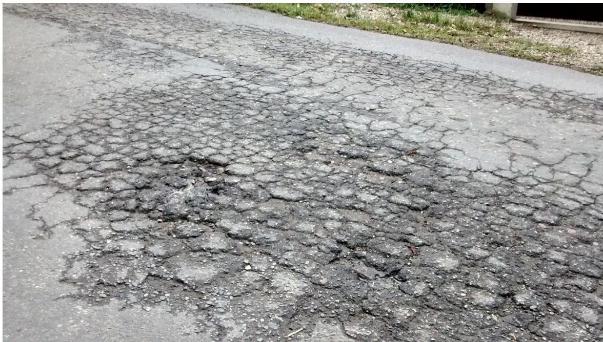
Imagen 4 Deterioro de la carpeta asfáltica por el tipo de falla, “piel de cocodrilo”, con un nivel de afectación alto. Se puede observar la formación de un bache en la zona central y cantidad de agua contenida en él. Sector 2.
