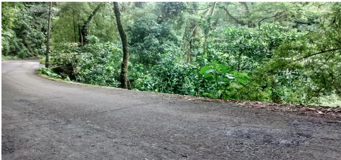
Imagen 1 Carencia de barandas de seguridad vial en curva del sector 1. Alto riesgo de accidentalidad.
