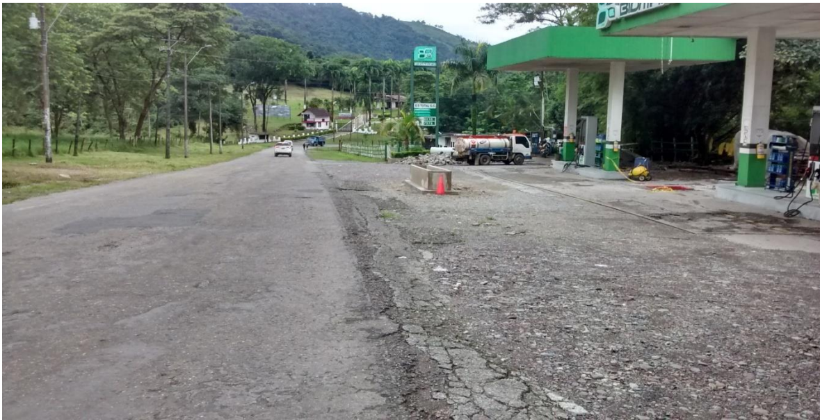
Imagen 17 Sector 3, estación de servicio Cimarrón, capa de rodadura de la estructura del pavimento es regular, no cuenta con deterioros tan grandes como los otros dos sectores. No se cuenta con obras de drenaje en este sector.
