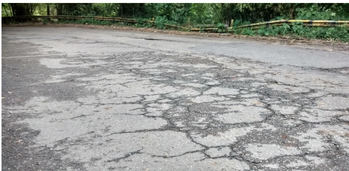
Imagen 8 Afectación en la carpeta asfáltica, con una lesión tipo piel de cocodrilo en el sector 1. Con un nivel de daño medio.
