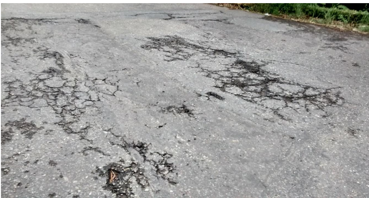
Imagen 16 Deterioro en la carpeta asfáltica en el sector 3, se encuentra una lesión tipo piel de cocodrilo, con un nivel de seriedad bajo, no se alcanza a observar parte de la base.
