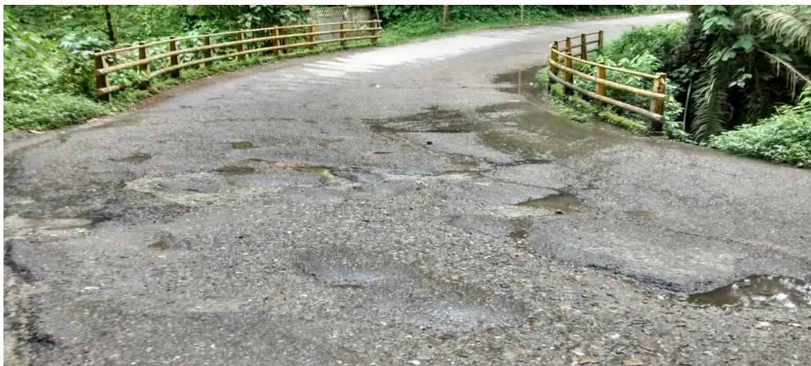
Imagen 10 Abultamientos y huecos con gran cantidad de agua escurrida de la montaña en el sector 2, riesgo de accidentalidad para motociclistas.
