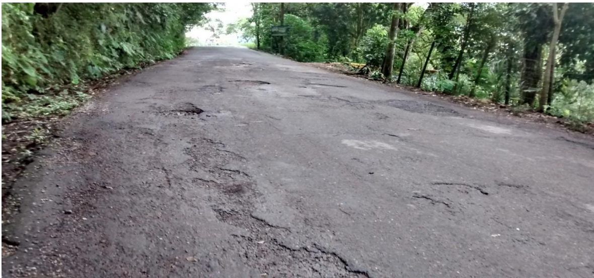
Imagen 12 Huecos en la capa de rodadura, con un nivel de seriedad medio. Sector 2
