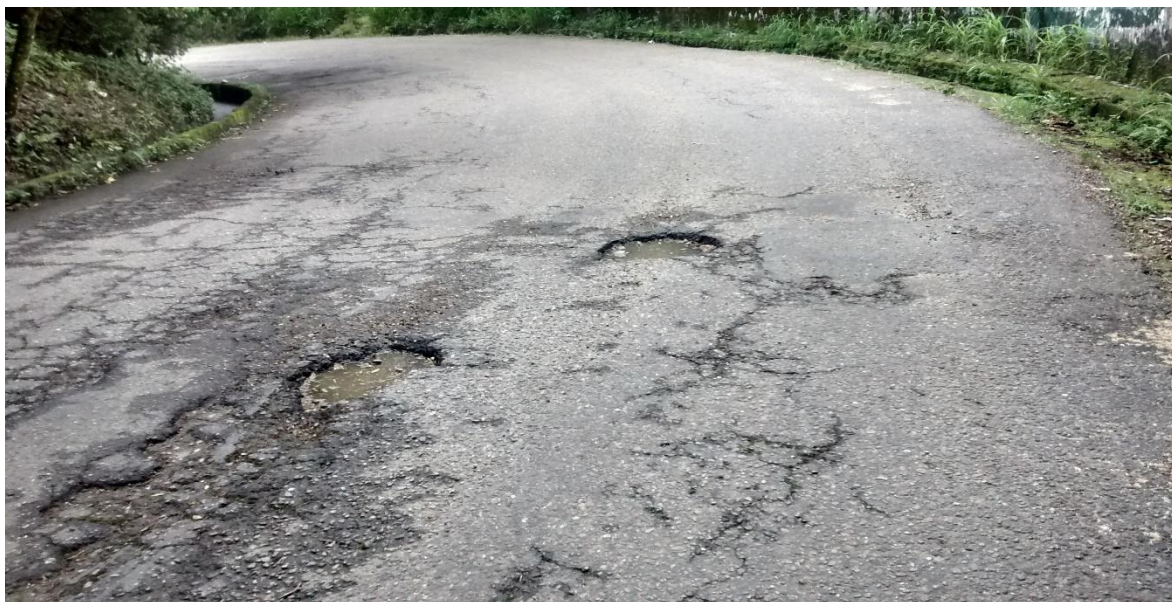
Imagen 7 Vía antigua hacia Restrepo, sector 1. Con deterioro en la capa de rodadura e índice de lesión tipo, piel de cocodrilo en la margen izquierda y en el centro afectación de baches, nivel de seriedad medio.
