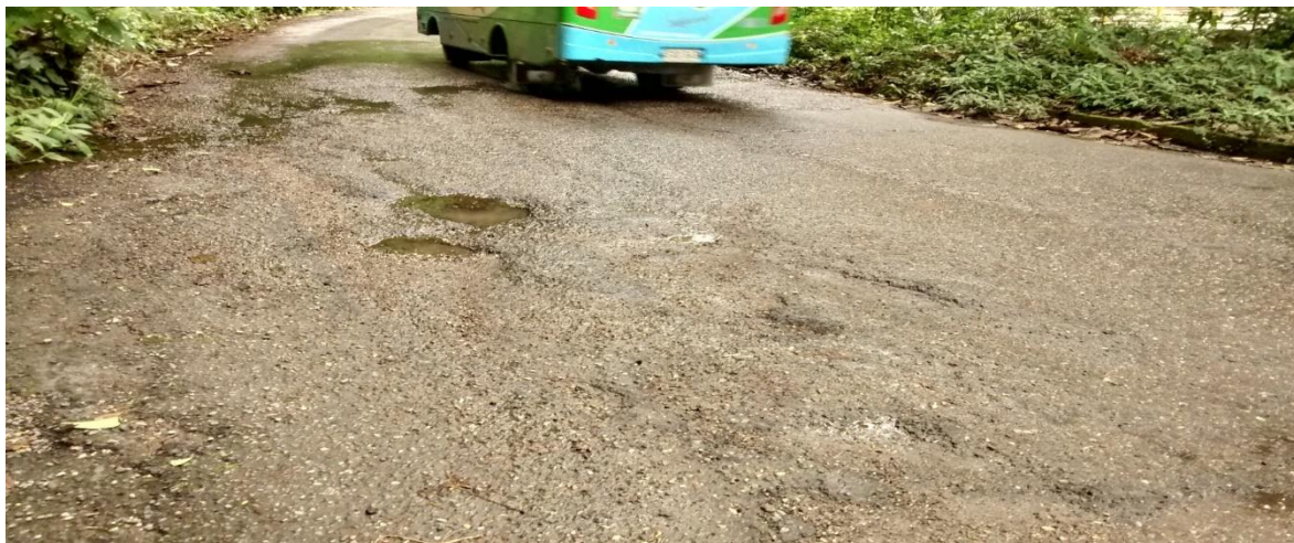
Imagen 9 Afectación por huecos y abultamientos en la carpeta asfáltica en el sector 2. Se observa gran cantidad de agua que escurre de la montaña, causando un deterioro más al pavimento.
