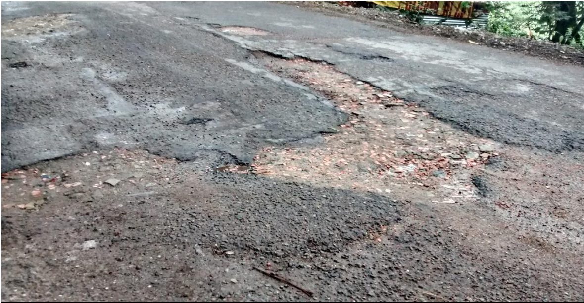
Imagen 13 Falla de la carpeta asfáltica. Huecos con un nivel de seriedad alto, se rellenó con escombros, material ajeno a la estructura del pavimento. Sector 2. Gran riesgo de accidentalidad.
