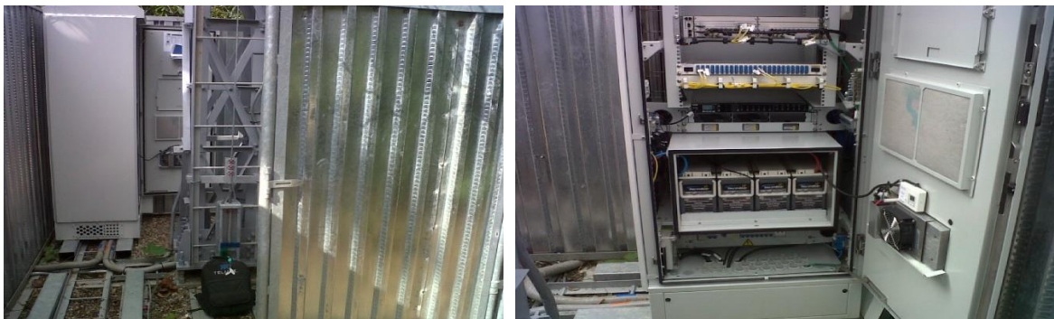
Figura 80. Fotografías del acceso a los ODF'S Arboledas.
