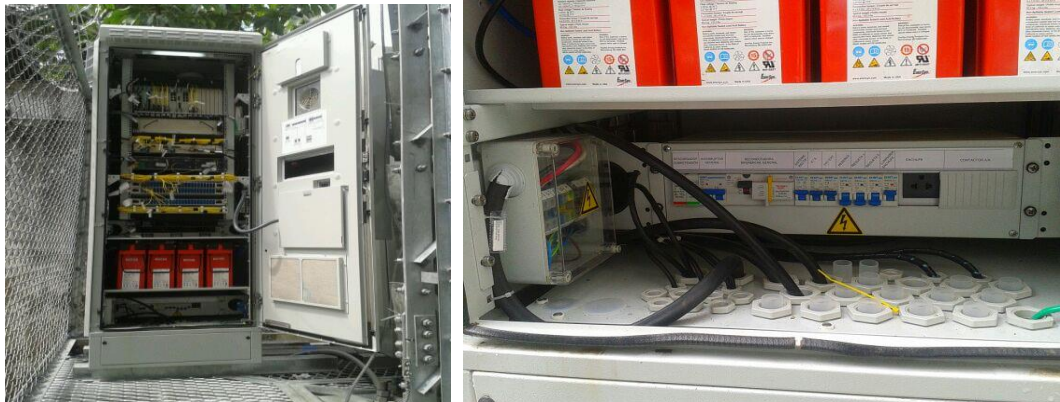
Figura 128. Fotografías del acceso a los Equipos.
