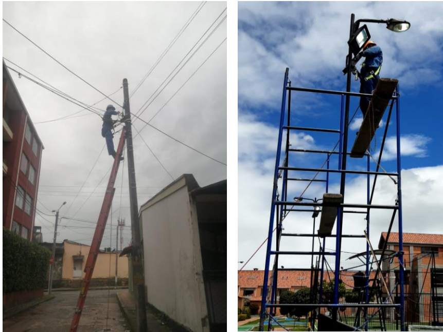
Figura 9. Prácticas inadecuadas en el desarrollo de trabajo en alturas
