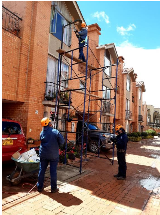
Figura 8. Prácticas inadecuadas en el desarrollo de trabajo en alturas
