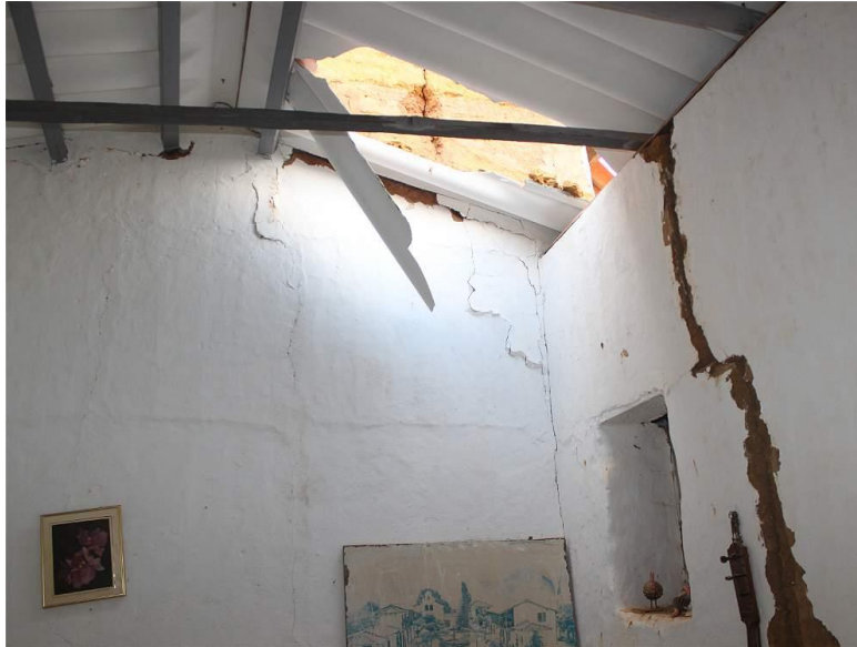
Figura 5. Casa destruida por el terremoto del 10 de marzo del 2015
