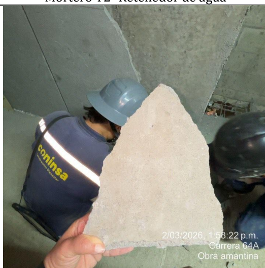
Falla del mortero por falta de adherencia
