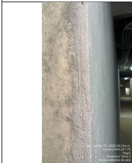
Inicio de falla mortero T1
