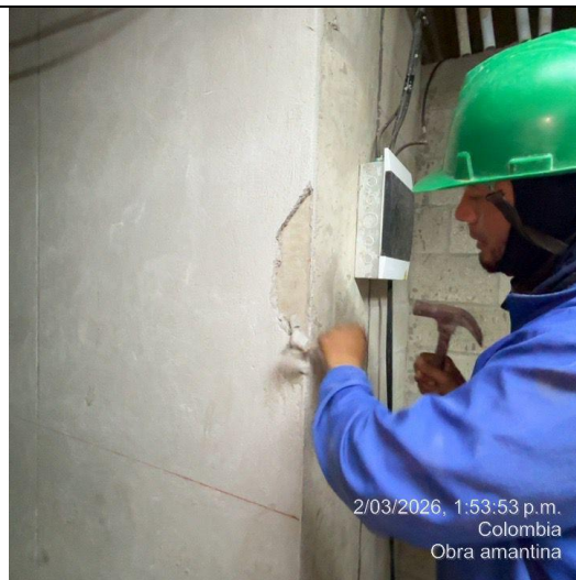
Falla por cohesión del sustrato- Mortero T1
