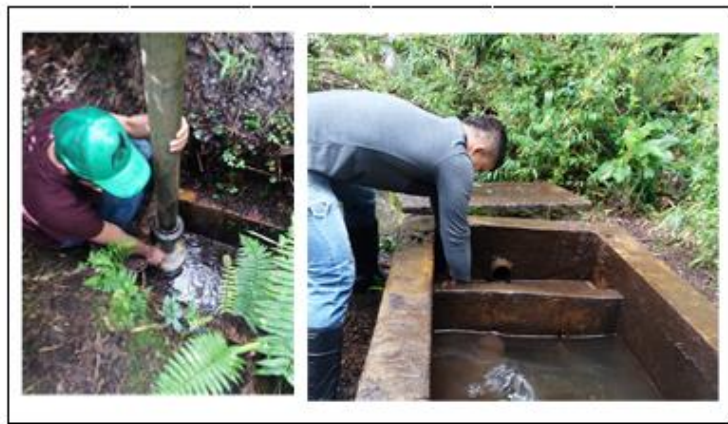
Figura 2. Aforado bocatoma y desarenador
