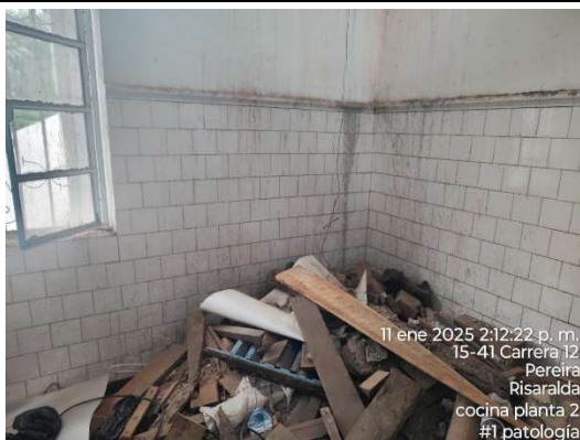
Figura 7 Registro fotográfico de inspección visual de nivel 1
