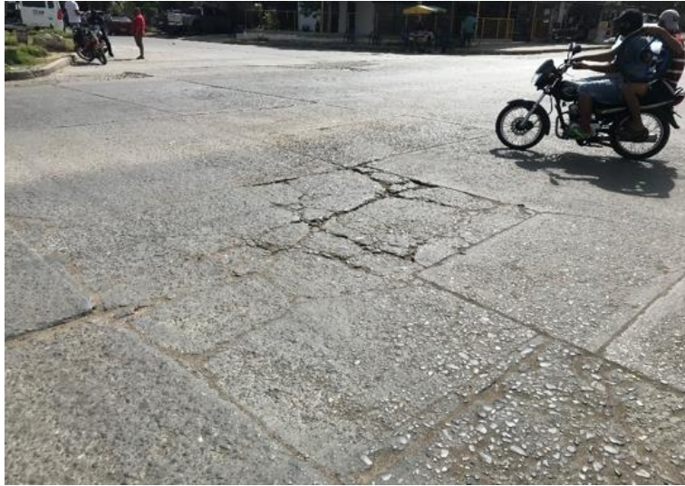
Hundimiento o asentamiento en losa de concreto hidráulico
