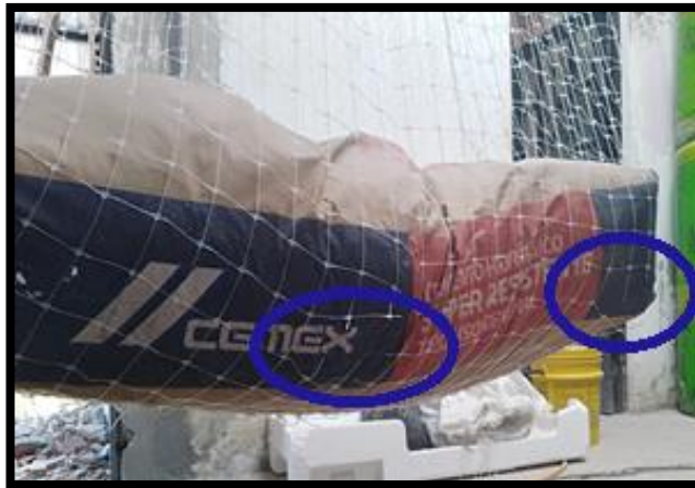
Imagen 10.22: Falla en prueba de carga de la malla industrial plástica. Fuente 75: Autor.
