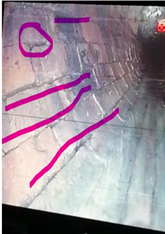
Ilustración 4 Pérdida de parte de la mampostería
