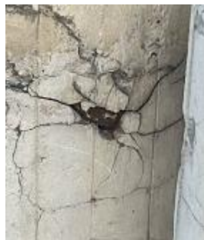
Foto 3. Imagen a detalle del acero expuesto
