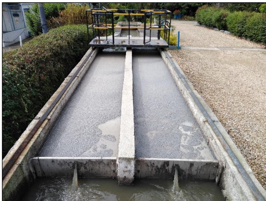
Imagen 24. Ingreso de grasa al tratamiento secundario a través del desarenador
