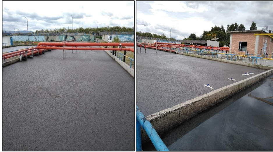
Imagen 25. Capa de grasa en sistema de Reactores Biológicos
