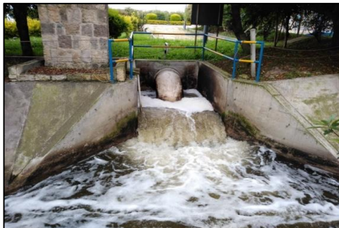
Imagen 20. Tubería de Salida Sistema SBR
