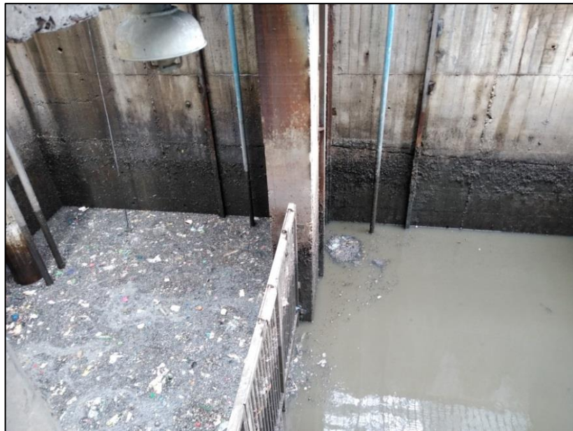
Imagen 22. Rejilla de cribado
