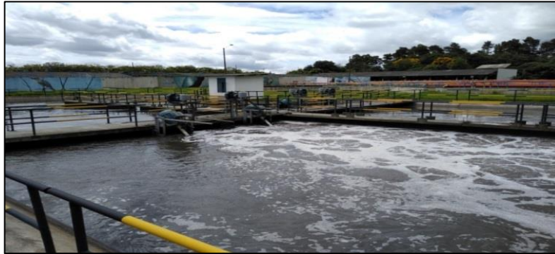
Imagen 16. Zanjón de Oxidación Sistema de Lodos Convencional
