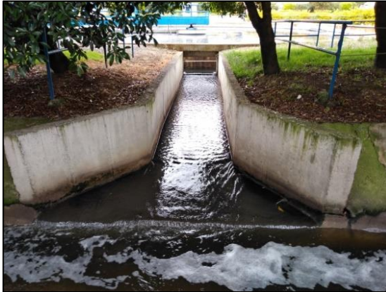
Imagen 21. Canal de Salida Sistema Convencional
