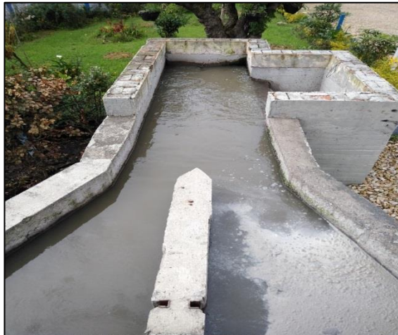
Imagen 23. Vertedero de excesos desarenador
