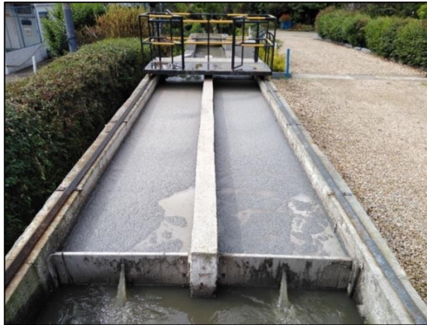
Imagen 13. Desarenador de canal doble PTAR Municipio de Funza
