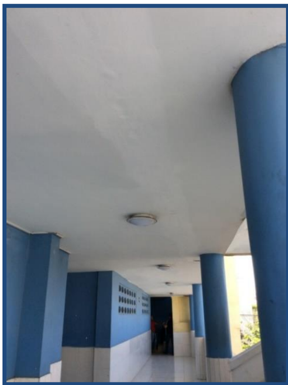
Figura C9-7. Lesión: desnivel en losa del tercer piso. Fuente: Autores.
