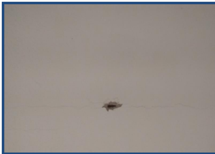
Figura C9-10. Lesión: pérdida de recubrimiento. Fuente: Autores.
