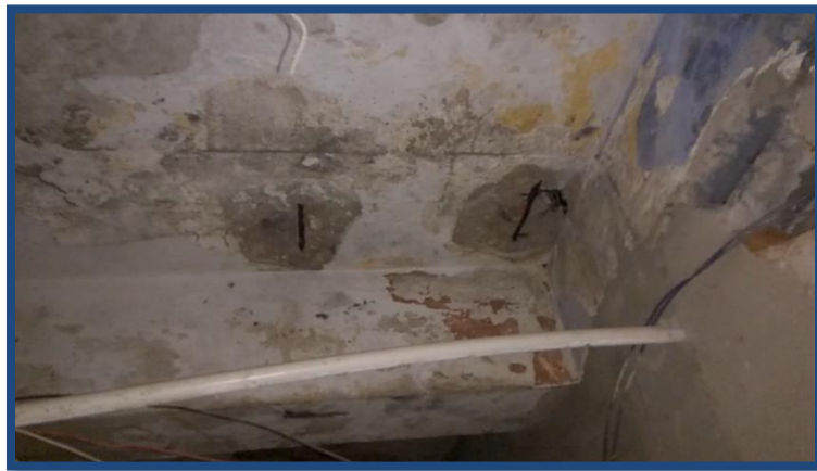
Figura C9-6. Lesión: pérdida de recubrimiento. Fuente: Autores
