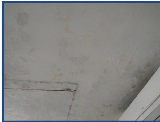
Figura C9-9. Lesión: humedad en losa de entrepiso. Fuente: Autores
