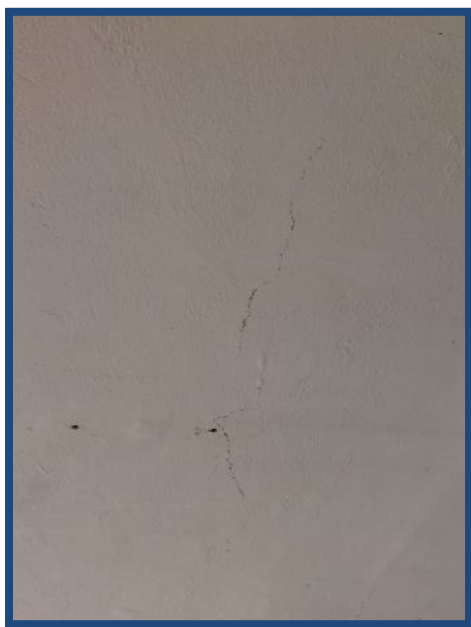
Figura C9-8. Lesión: fisura en losa. Fuente: Autores
