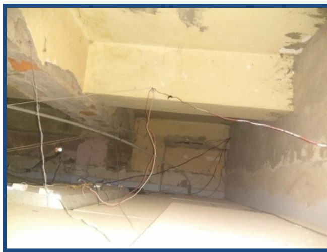
Figura C9-5. Lesión: pérdida de recubrimiento. Fuente: Autores
