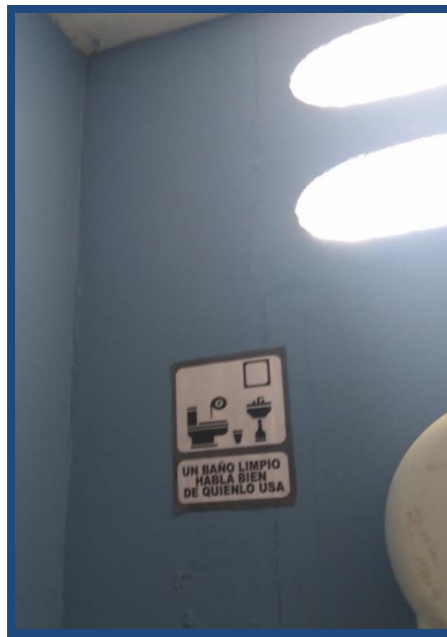
Figura C9-11. Lesión: fisura en muro
