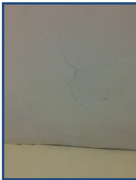
Figura C9-8a. Lesión: fisura en losa. Fuente: Autores.
