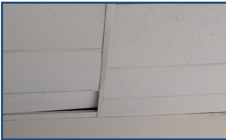
Figura C12-27. Cieloraso edificio #1. Fuente: Propia
