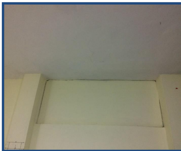
Figura C9-8b. Lesión: separación de elementos no estructurales. Fuente: Autores.
