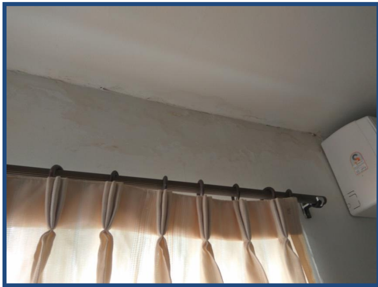
Figura C9-1. Lesión: humedad. Fuente: Autores.
