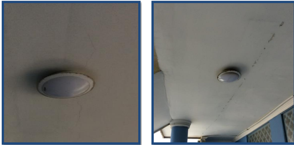
Figura C9-12. Lesión: fisura en losa. Fuente: Figura C9-12a. Lesión: fisura en losa. Autores.
