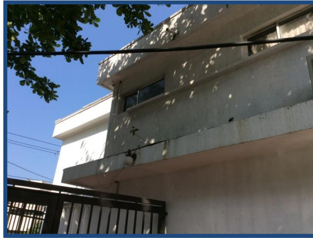
Figura C9-4. Lesión: humedades. Fuente: Autores.
