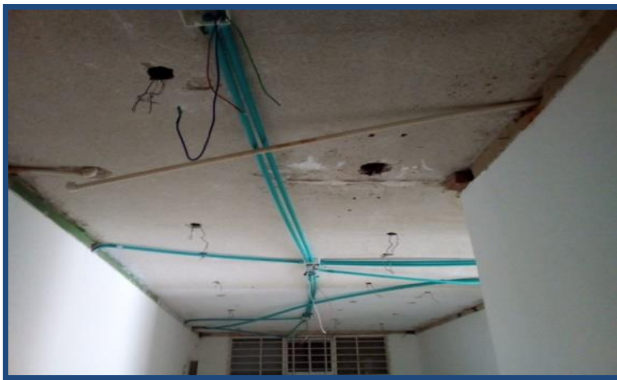
Figura C12-26. Cieloraso edificio #1. Fuente: Propia
