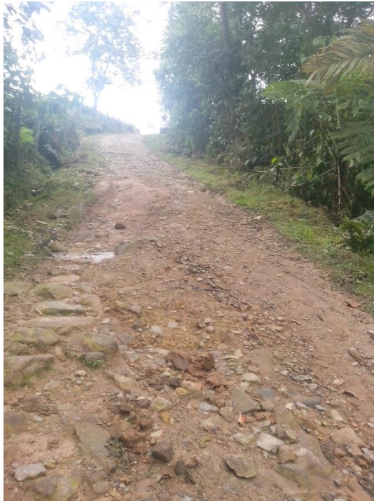
Figura 3: Estado de la vía en el tramo anterior a la quebrada
