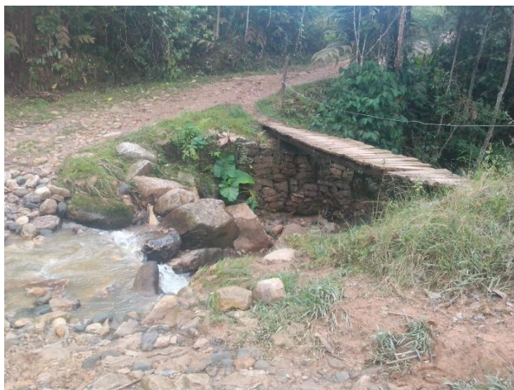
Figura 2: Estado de la vía en el tramo del paso de la quebrada, puente provisional
