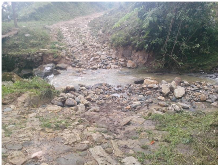
Figura 1: Estado de la vía en el tramo del paso de la quebrada (verano)
