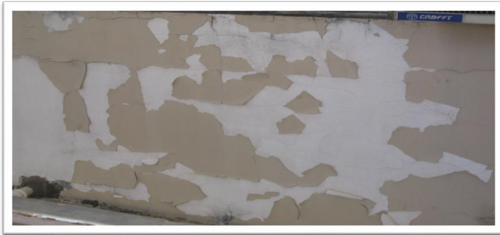
Ilustración 10. Afectaciones en revoques y pinturas.
