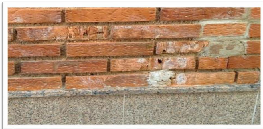
Ilustración 9. Erosión física debido a la absorción capilar en C/ La Corredera
