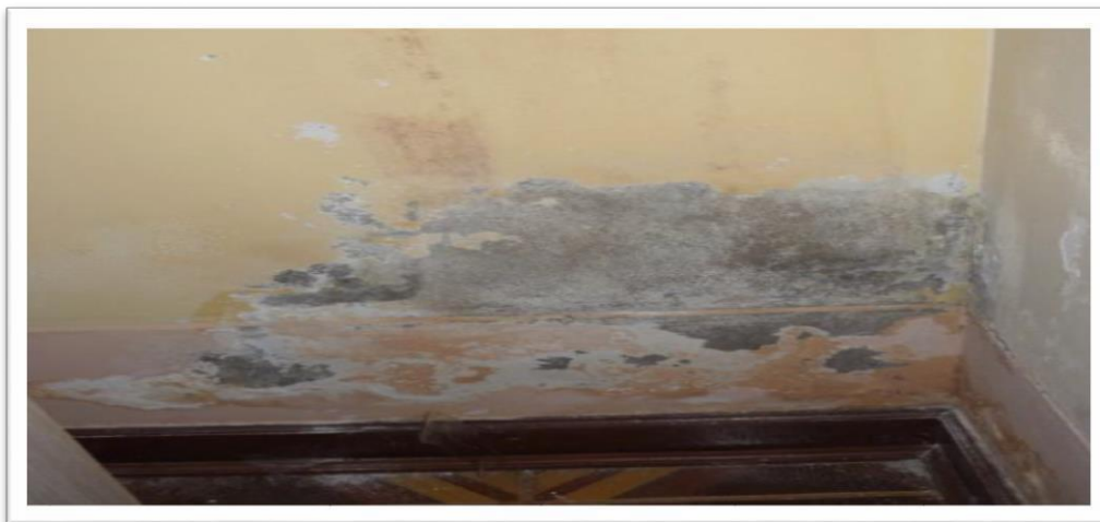
Ilustración 11. Muro con mancha circular intensa en dormitorio
