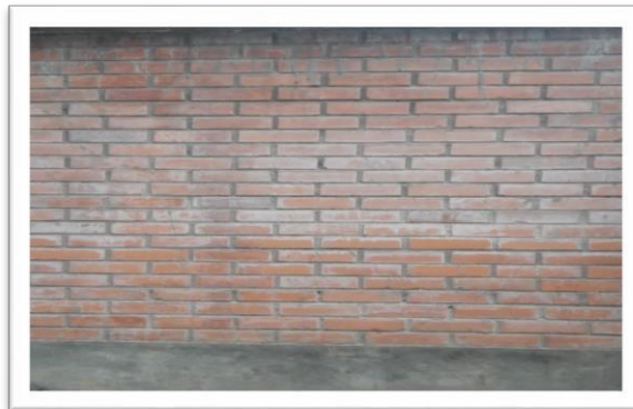
Ilustración 17. Patología de eflorescencia
