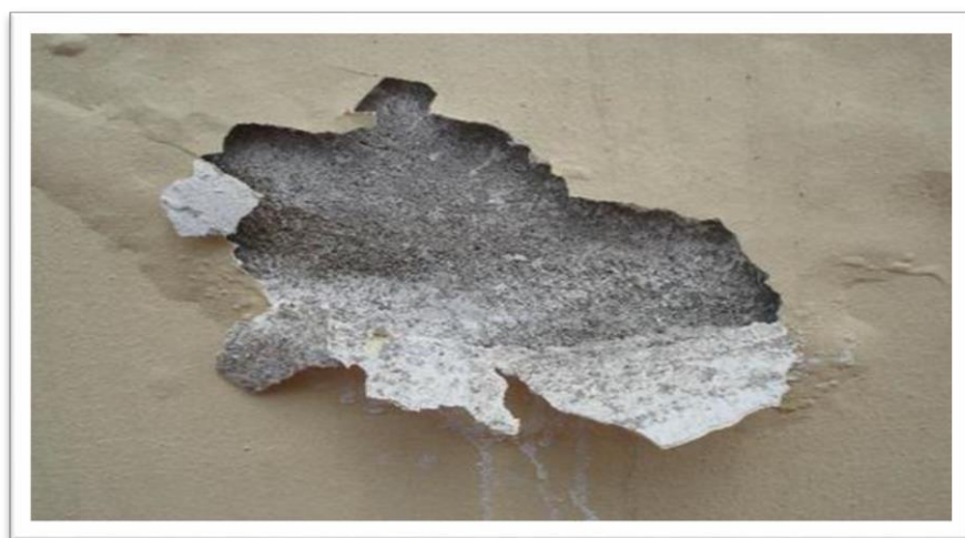
Ilustración 15. Desprendimiento de la pintura por alto contenido de sales en el pañete, generando así eflorescencias.
