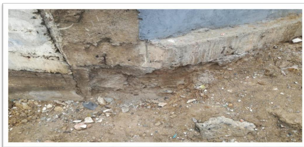
Ilustración 12. Patología de erosión en Sobrecimiento.
