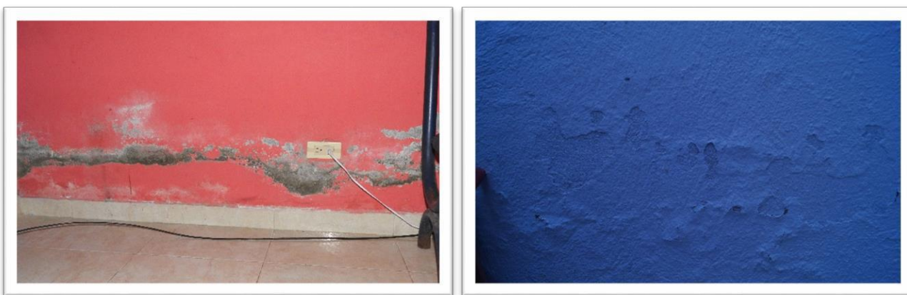
Ilustración 7. Lesiones presentes en muros en el conjunto residencial Guazuca.
