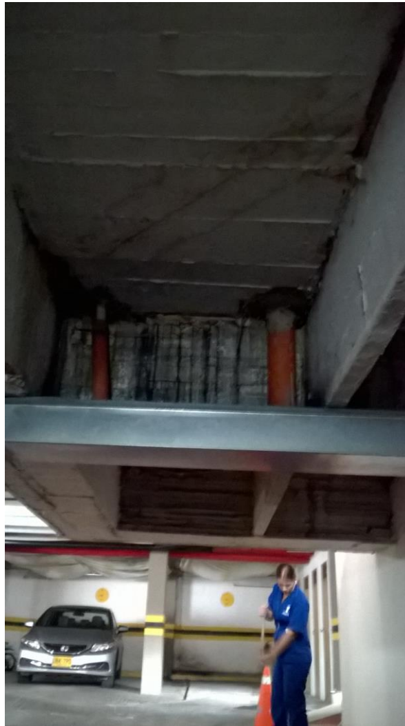
Foto 14. Eflorescencias originadas en el lavado del material cementante de la losa estructural.
