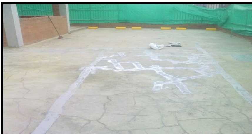
Foto 27. Punteo de fisuras. Fuente: construcción autores
