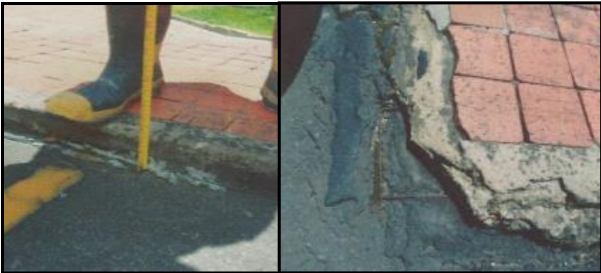
Foto 16. Hay deficiencia en los niveles. Fuente: construcción autores
