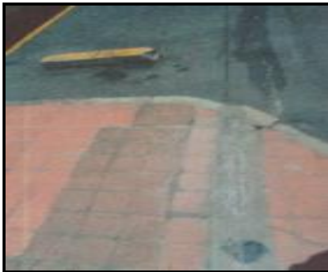
Foto 11. Algunas fisuras observadas en la parte superior de la losa. Fuente: construcción autores
