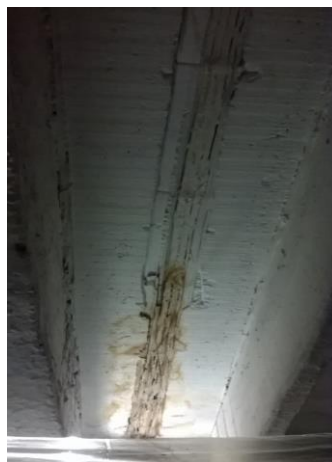
Foto 12. Fisuras que se observan por toda la losa, algunas son aleatorias. Fuente: construcción autores
