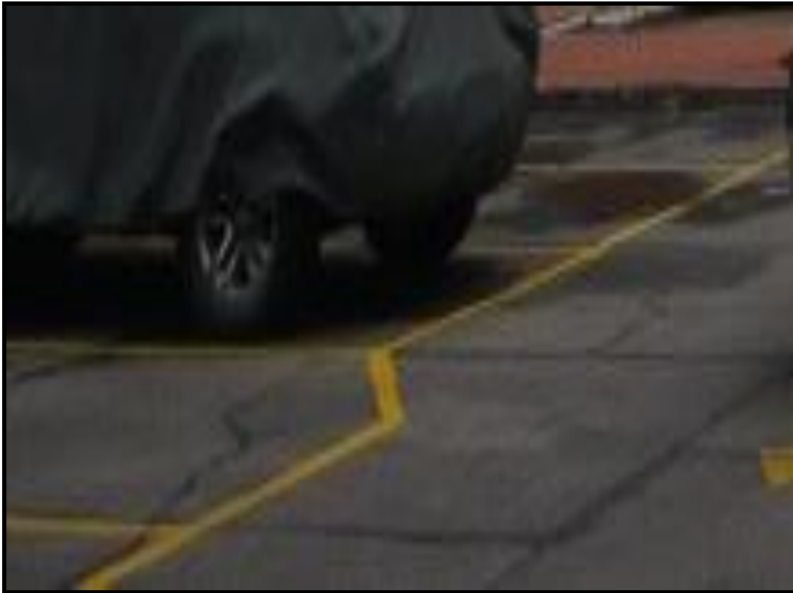
Foto 8. Filtraciones que hoy presenta la Plataforma en estudio. Fuente: construcción de los autores
