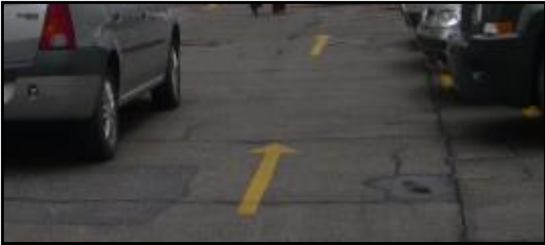
Foto 9. Fisuras presentadas en diferentes partes de la losa. Fuente: construcción autores
