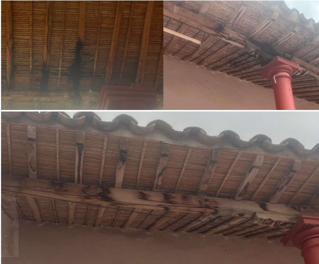
Figura 7. Estado Actual de la Cubierta Complejo Histórico La Gran Convención
