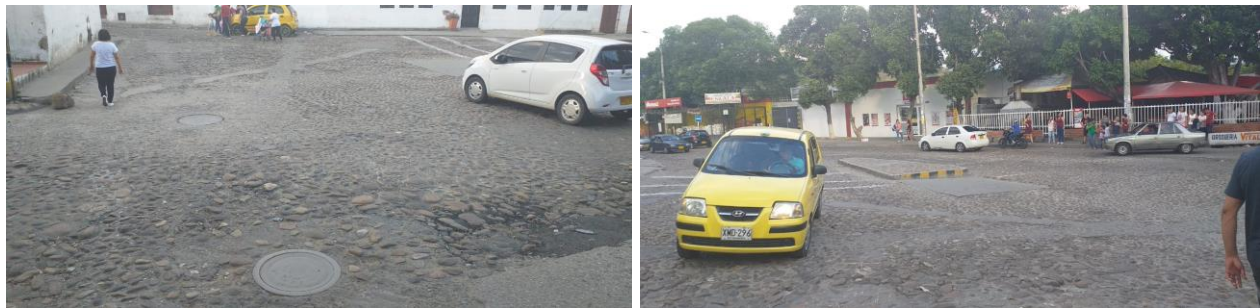
Figura 19. Evidencia del mal estado de la calzada de la carrera 23
