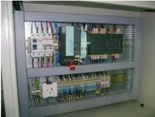
Figura 1 Tablero De Mando Y Potencia Para Bombas 380 V Y 220 V (ARGENTINA)
