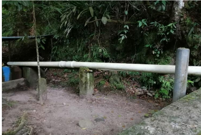
Figura 24. Tubo de conducción del agua
