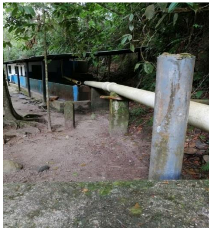
Figura 26. Tanques de Almacenamiento
