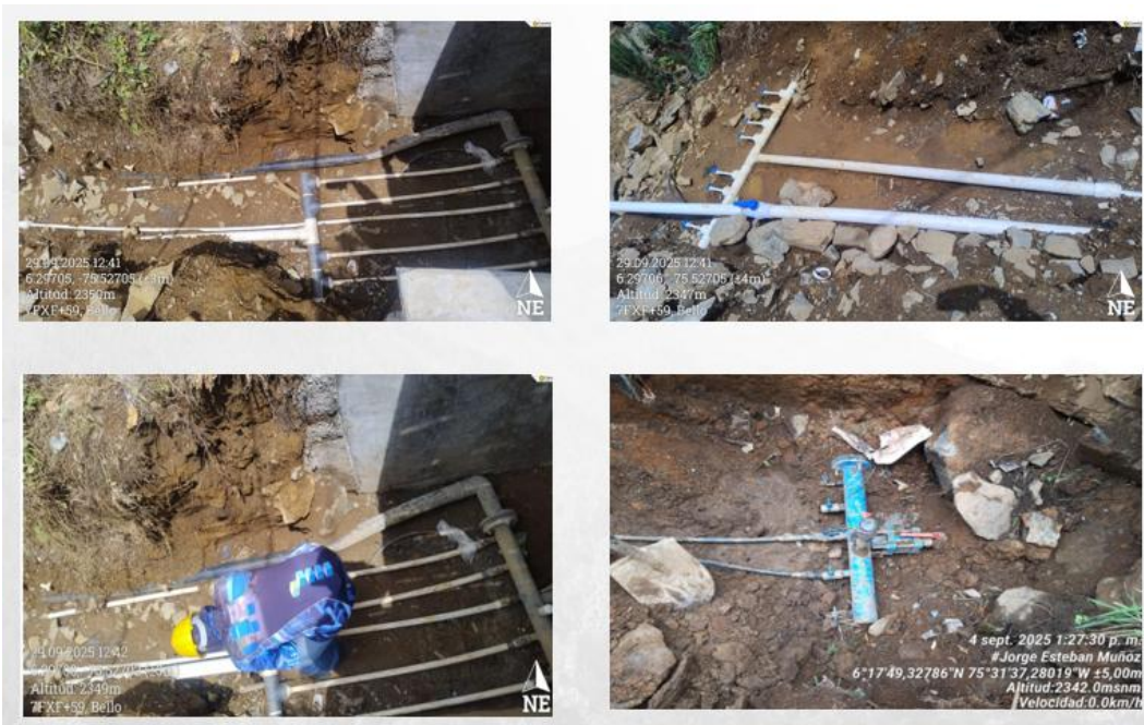
Figura 22. Punto de abastecimiento: flauta de conexión al canal de agua cruda de EPM Fuente: PIXADES S.A.S. (2025).
