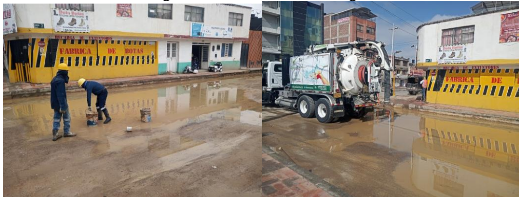
Figura 18. Evacuación de agua
