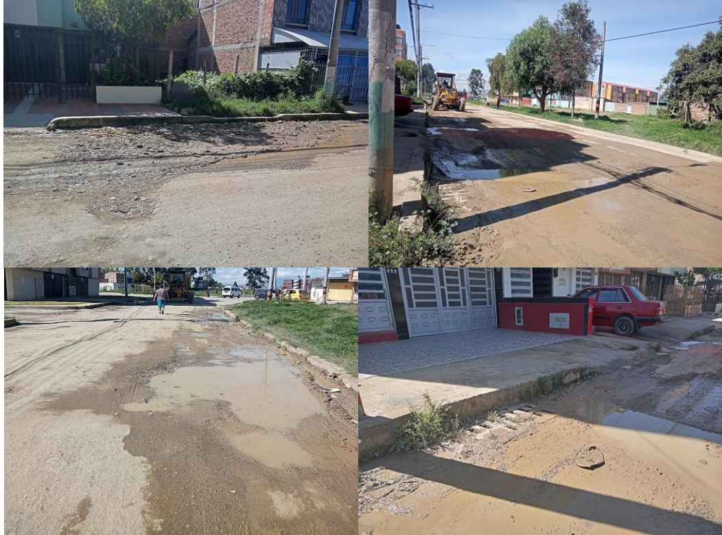
Figura 25. Estado inicial tramo vial carrera 20 entre calles 22ª y 27
