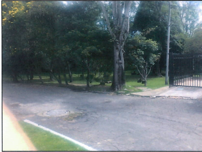
Fotografía No. 8 se observa ondulación en andén y calzada frente al predio KR 71 F #116 A-96 al parecer por causa de los árboles.
