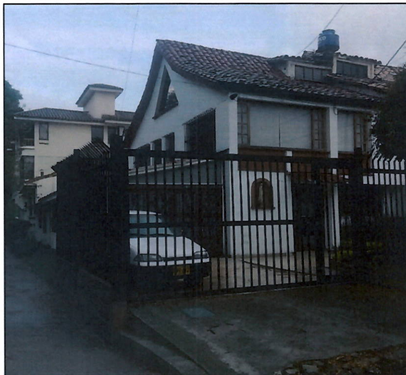
Fotografía No. 3 Tomada el día 4 de febrero de 2019 Predio KR 71F No. 116A – 96, se aprecian grietas en fachada sobre la virgen.
