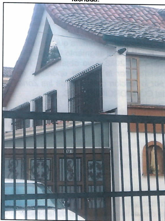
Fotografía No. 2 Tomada el día 4 de febrero de 2019 Predio KR 71F No. 116A – 96, se aprecian grietas en fachadas.
