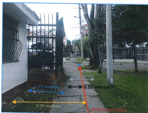
Imagen No. 3 Se observa cerramiento a espacio público por parte del predio KR 71F No. 116A – 96, longitudes en el punto de afectación respecto de la red de alcantarillado.
