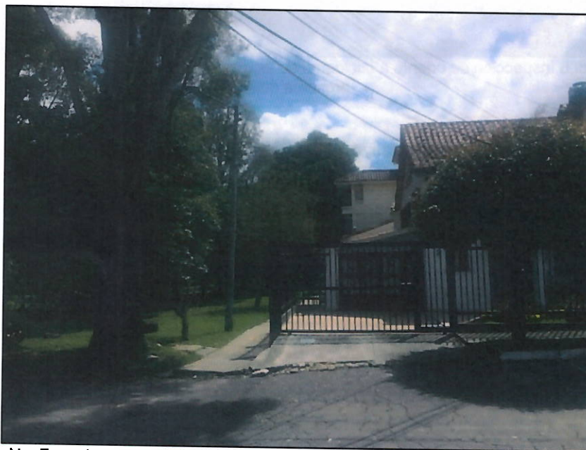
Fotografía No. 7 se observa ondulación en andén y calzada frente al predio KR 71 F #116A - 96 al parecer por causa de los árboles.
