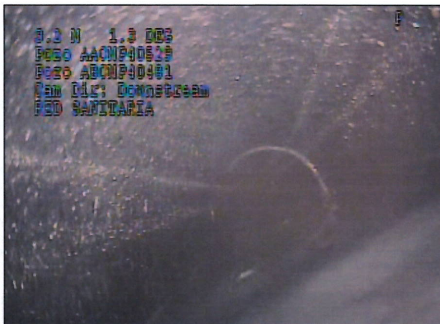
Fotografía No. 6 Inspección de oriente a occidente se logró inspeccionar 6 metros, hasta donde la tubería presenta colapso
