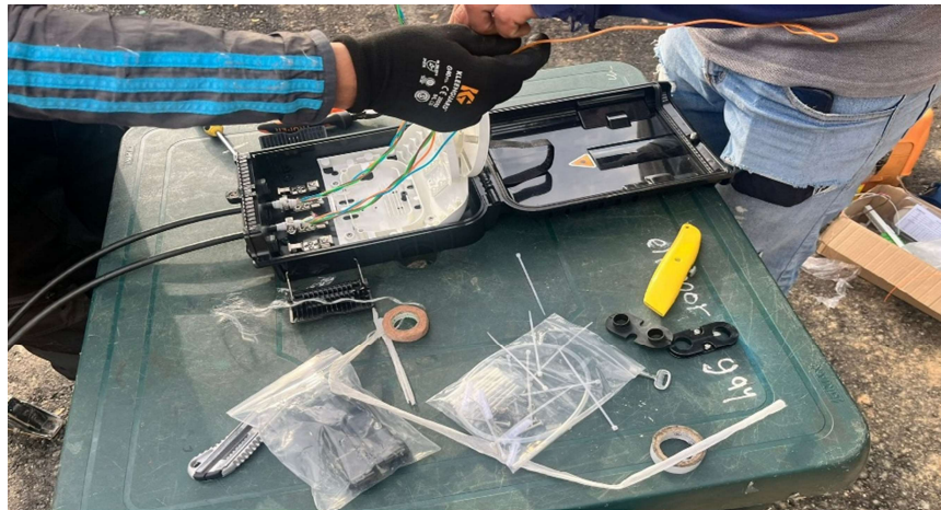
Figura 23. Instalación de caja NAP de derivación para almacenamiento y distribución de fibra óptica hacia las ONUs de los usuarios
