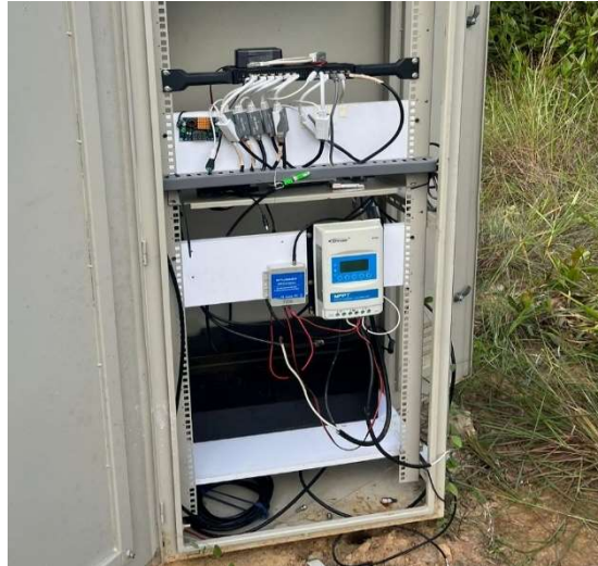
Figura 18. Gabinete de telecomunicaciones para recepción de enlace de radiofrecuencia y distribución hacia el sistema híbrido FO–RF.
