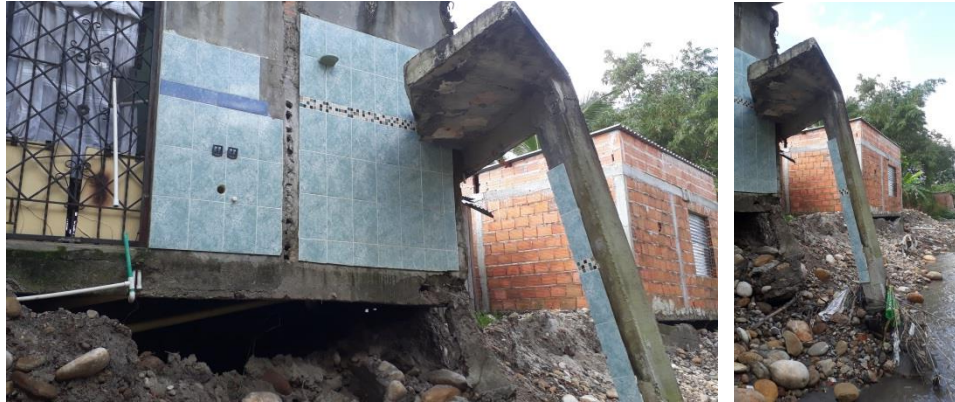
Figura 1. Casas ribereñas afectadas, tomada por Edier Andrés Chilito Rincón, 2018.
