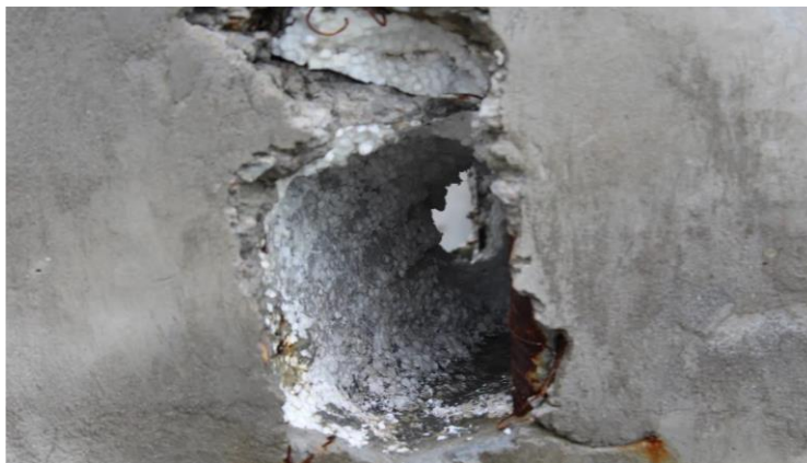
Ilustración 15. hueco pasante expuesto en columna
