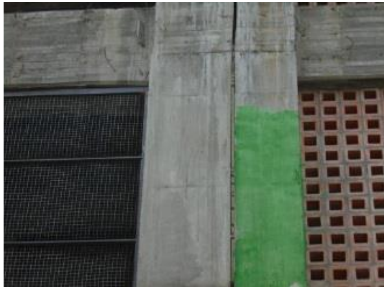
Ilustración 22. escasas de separación entre estructuras continuas
