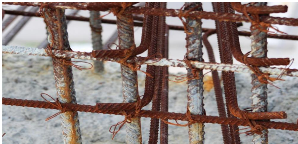
Ilustración 20. corrosión en aceros expuestos
