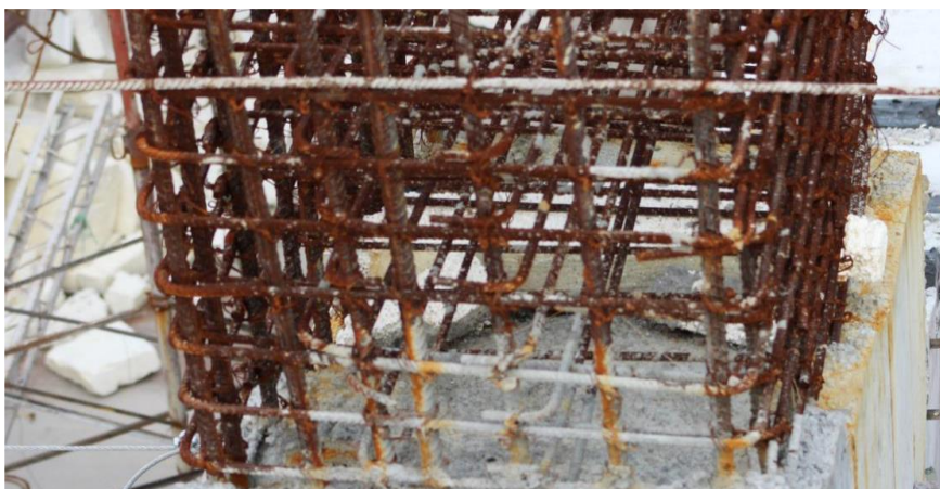
Ilustración 19. corrosión en aceros expuestos
