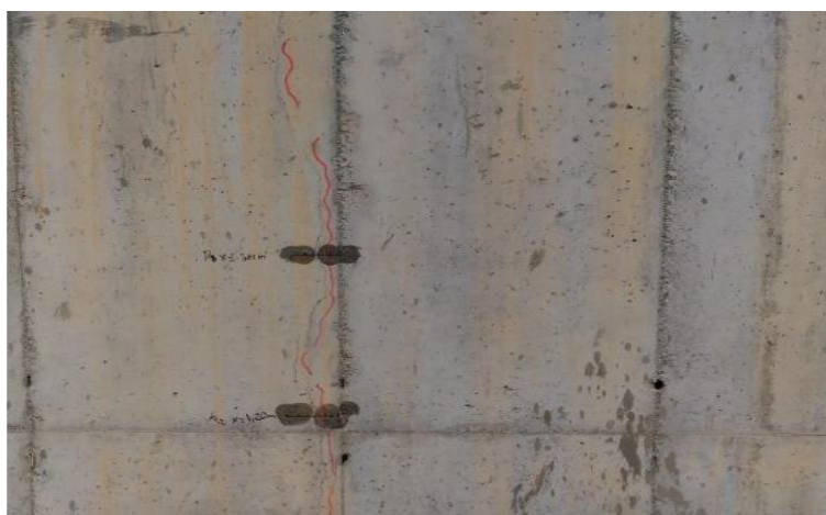
Ilustración 16. fisuras en muro
