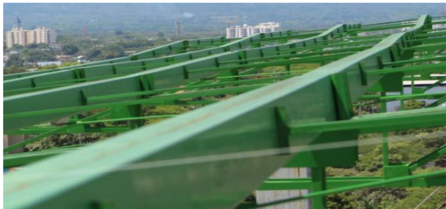
Ilustración 17. irregularidad en estructura de cubierta
