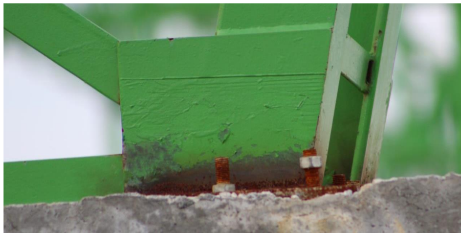
Ilustración 18. corrosion en anclajes
