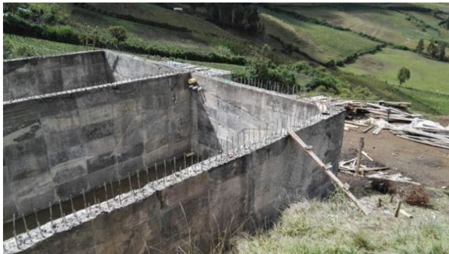
Alineamiento vertical del acero de refuerzo.
