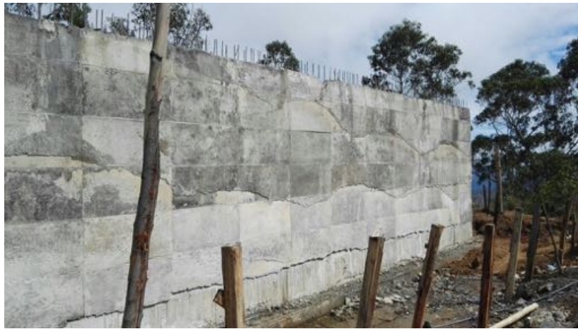
Huella en el exterior de muro lateral.
