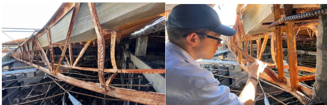
Figura 7. Oxidación de la estructura metálica por incendio.
