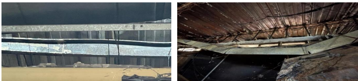
Figura 10. Revestimiento y acabados afectados.
