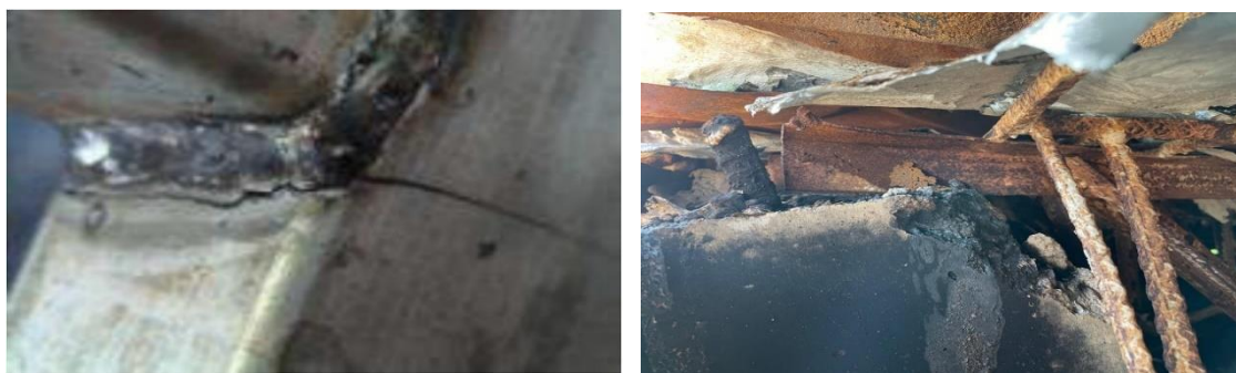
Figura 9. Roturas en soldaduras y uniones.
