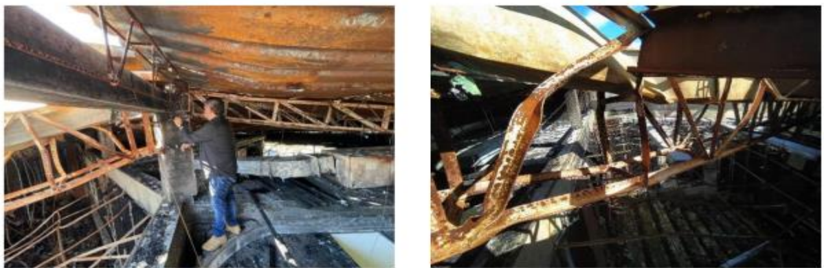
Figura 5. Muestra de deformación y pérdida de estabilidad de elementos de cubierta del auditorio
