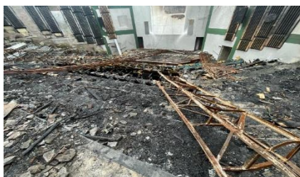
Figura 8. Colapso de la estructura por Reducción de la Integridad Estructural.
